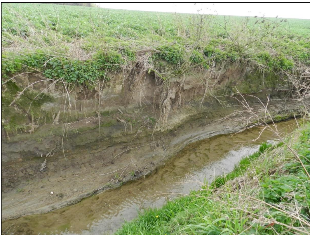
Obr. 18 Břehová nátrž na Chlebičovském potoku blízko NPP Odkryv v Kravařích (foto: Englischová Aneta, 8. 4 2017)
