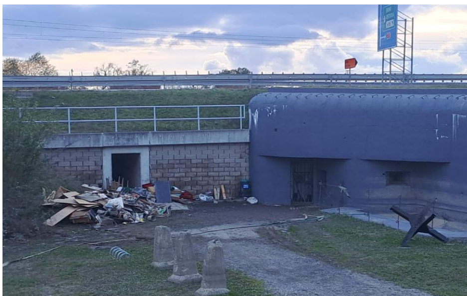
Obrázek 19: Objekt MO-S 5 „Na trati“ – po opadnutí vody
