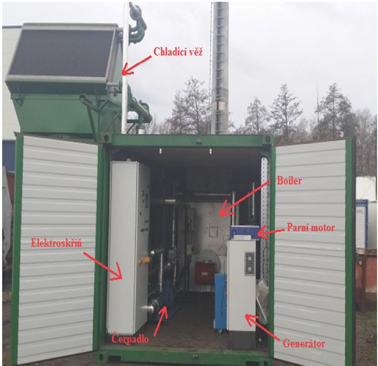
Obrázek 3.2: Reálná instalace ORC firmy PolyComp [13]
