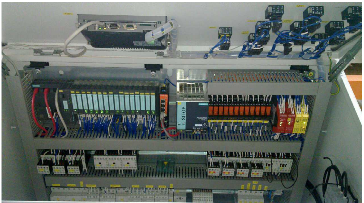
Obr. 4.1: Ovládací prvky rozvaděče
