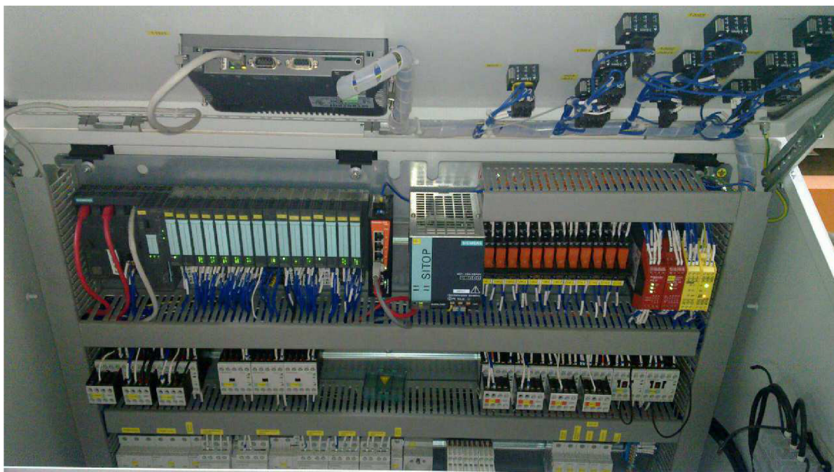
Obr. 4.1: Ovládací prvky rozvaděče
