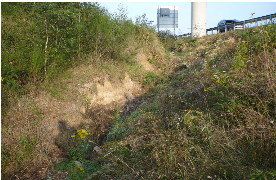
Obr. 18: Foto poškozeného svahu - srpen 2013 (záznam ŘSD)
