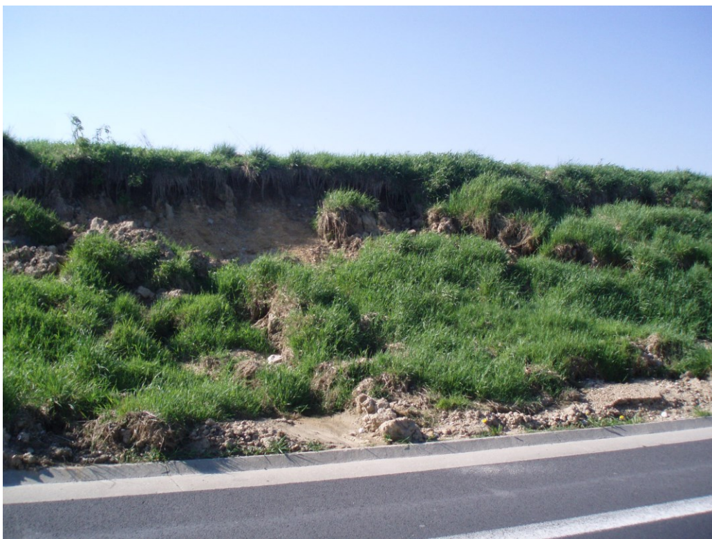
Obr. 9: Foto poškozeného svahu - duben 2008 (záznam ŘSD)
