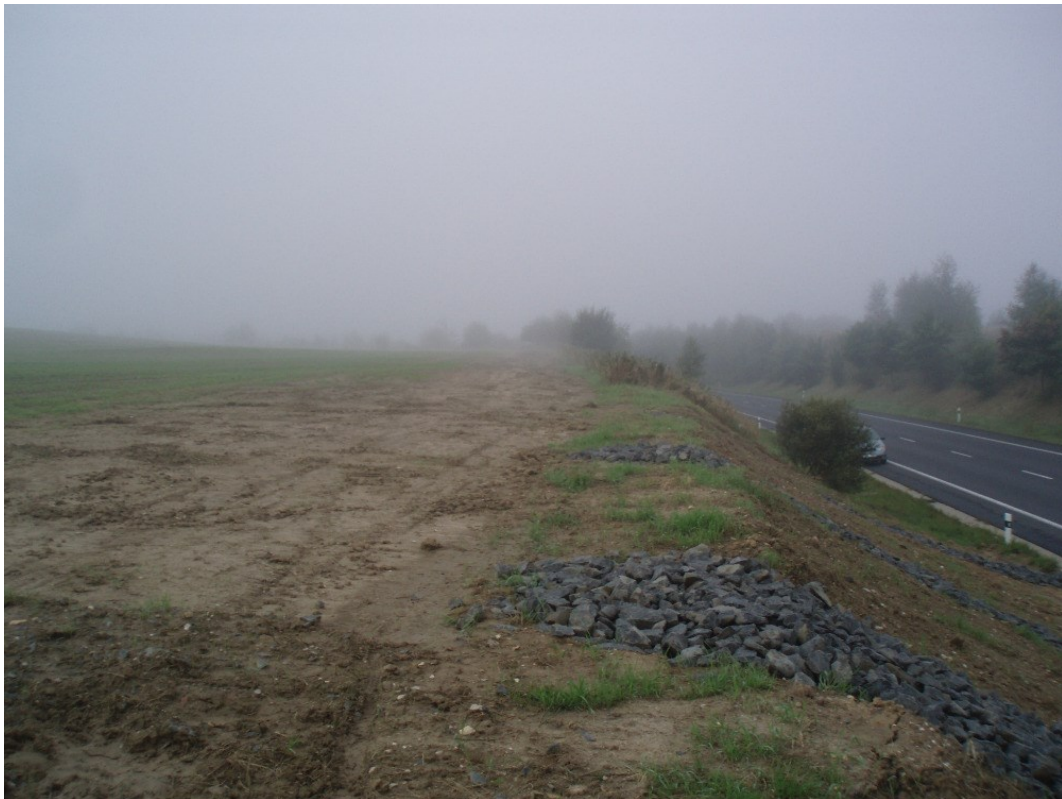
Obr. 12: Foto sanovaného svahu - září 2008 (záznam ŘSD)
