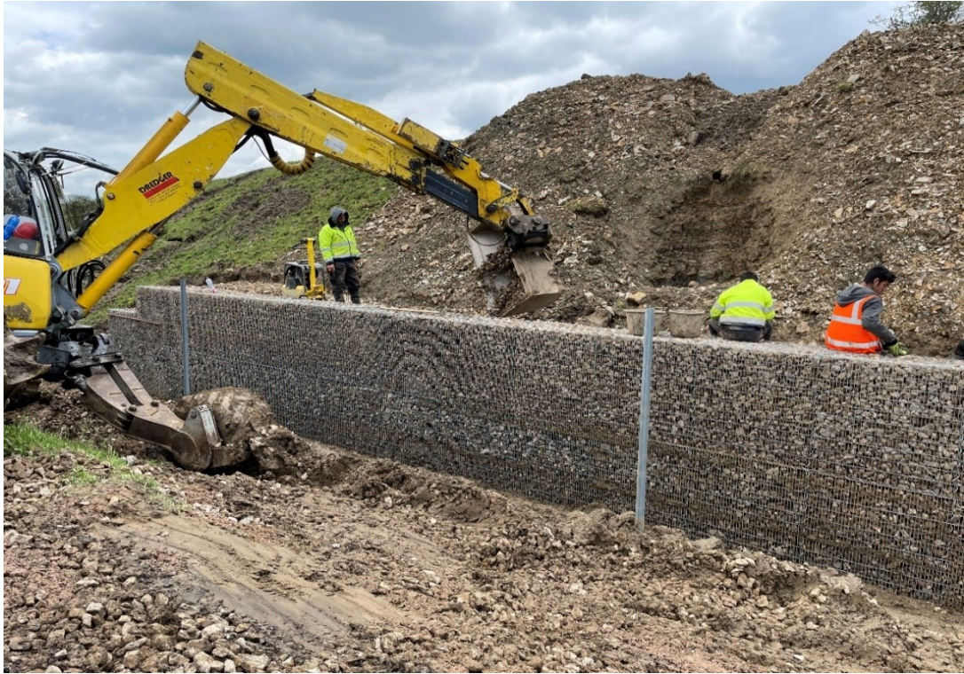
Obr. 28: Foto poškozeného svahu - průběh práce (autorka, 2020)
