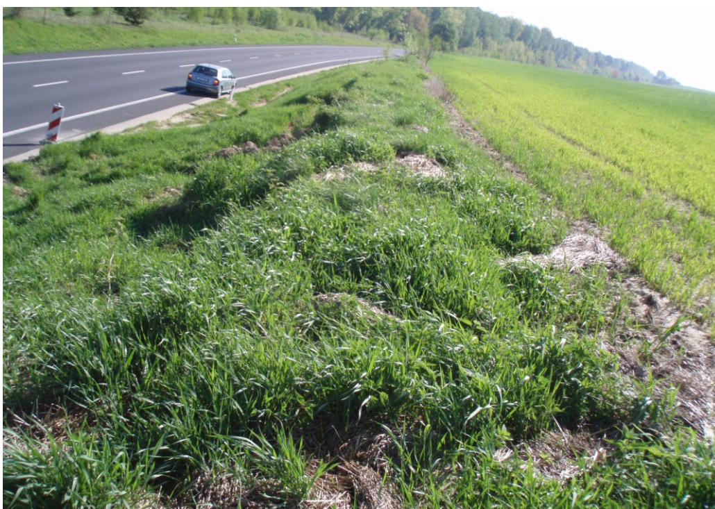
Obr. 10: Foto poškozeného svahu - duben 2008 (záznam ŘSD)
