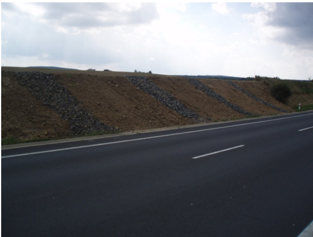
Obr. 11: Foto sanovaného svahu - září 2008 (záznam ŘSD)
