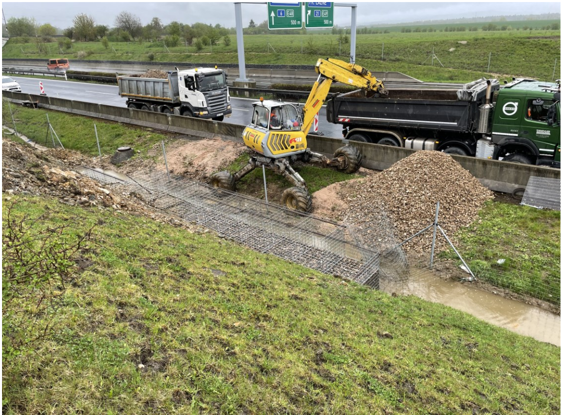
Obr. 26: Foto poškozeného svahu - průběh práce (autorka, 2020)
