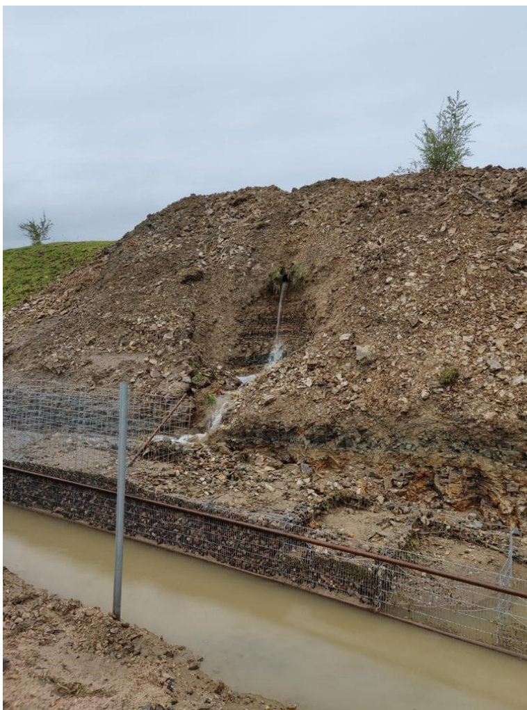
Obr. 25: Foto poškozeného svahu - průběh práce (autorka, 2020)
