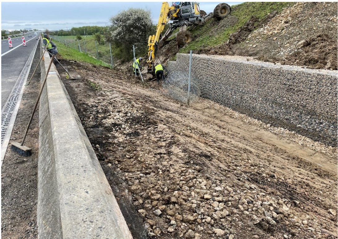
Obr. 27: Foto poškozeného svahu - průběh práce (autorka, 2020)
