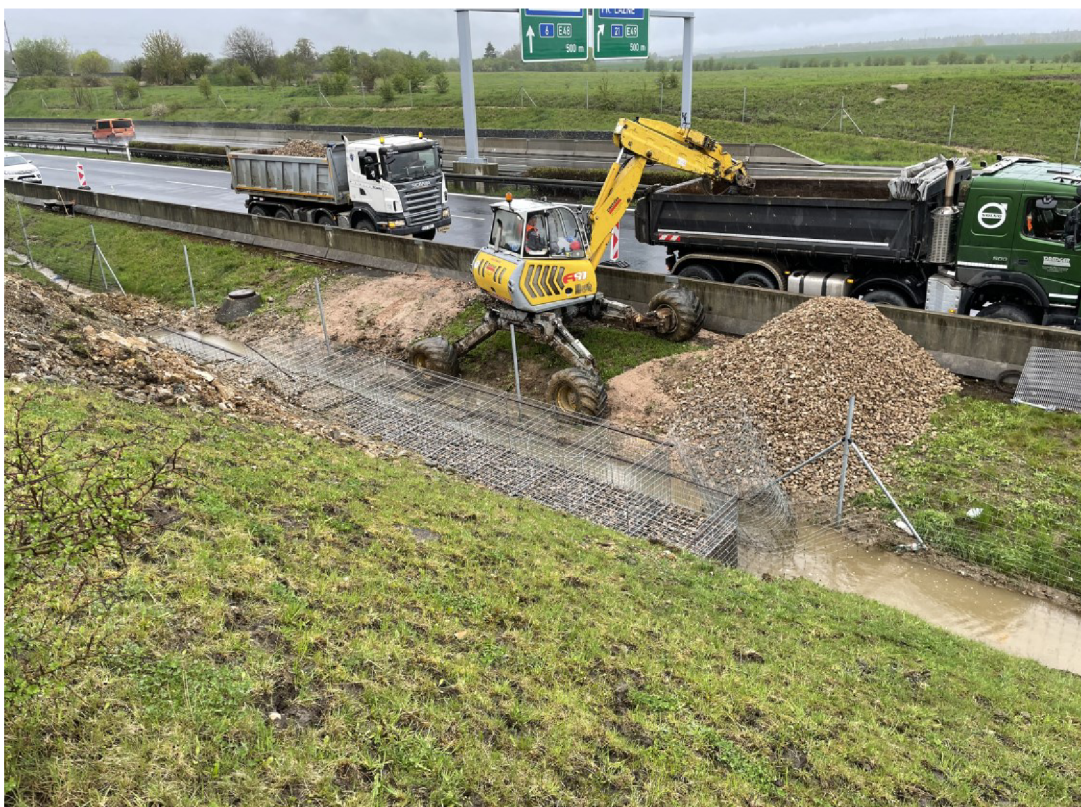
Obr. 26: Foto poškozeného svahu - průběh práce (autorka, 2020)
