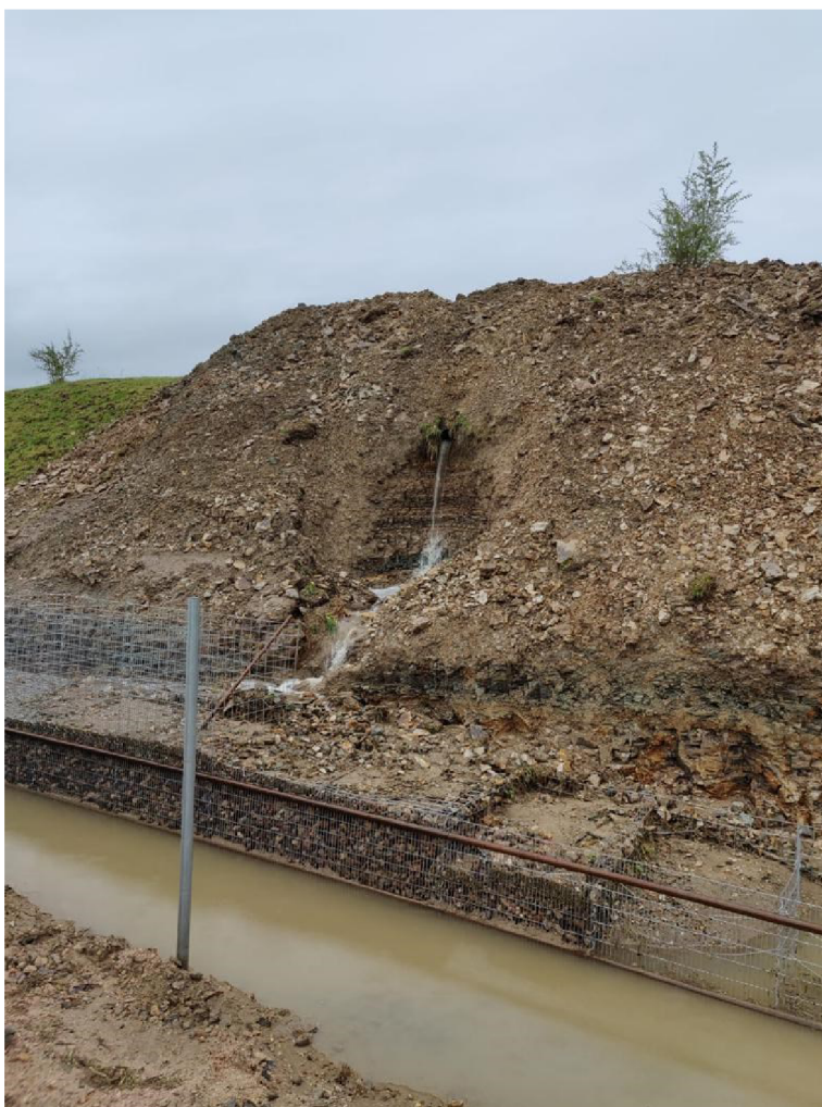
Obr. 25: Foto poškozeného svahu - průběh práce (autorka, 2020)
