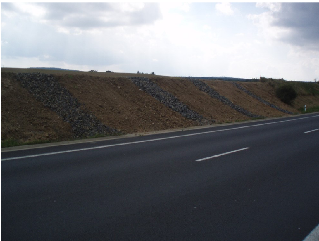
Obr. 11: Foto sanovaného svahu - září 2008 (záznam ŘSD)
