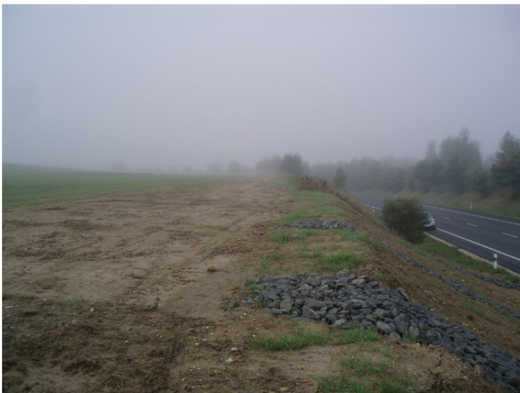
Obr. 12: Foto sanovaného svahu - září 2008 (záznam ŘSD)
