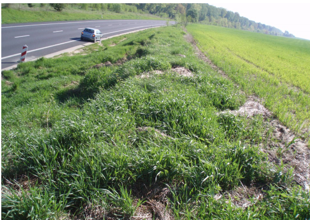
Obr. 10: Foto poškozeného svahu - duben 2008 (záznam ŘSD)
