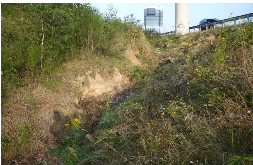
Obr. 18: Foto poškozeného svahu - srpen 2013 (záznam ŘSD)
