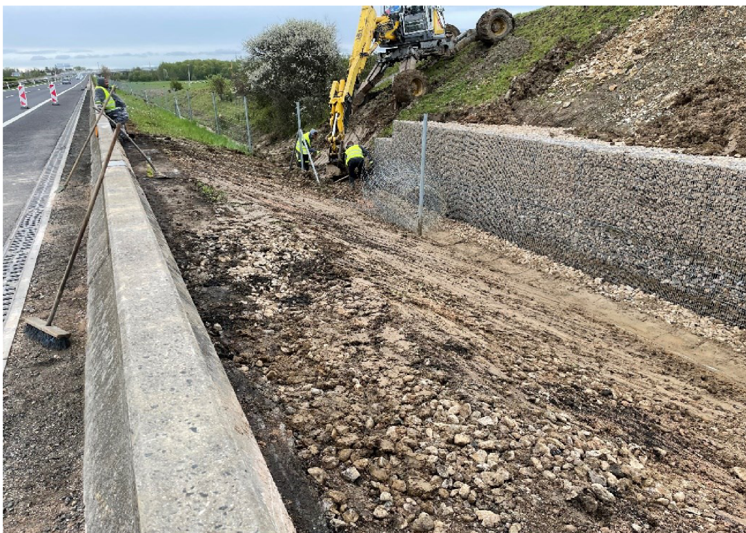
Obr. 27: Foto poškozeného svahu - průběh práce (autorka, 2020)
