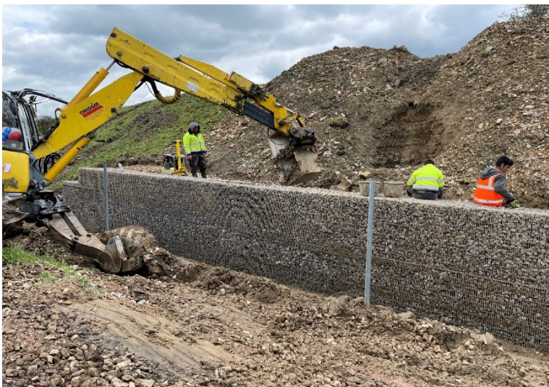
Obr. 28: Foto poškozeného svahu - průběh práce (autorka, 2020)
