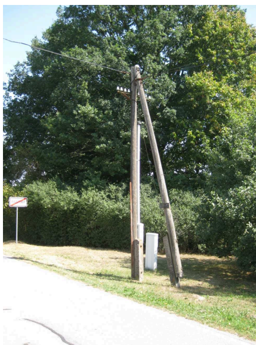
Příloha 42: Sloup s podpěrrou, kdy se dřevěná podpěra nedotýká země a je připevněna na betonový sokl. 471
