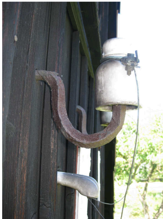
Příloha 46: Izolátor typu RM upevněný na háku. Tento typ izolátoru se používal nejčastěji na telefonní vedení, ale také na nízké napětí. Jílové u Držkova – severní Čechy. 475
