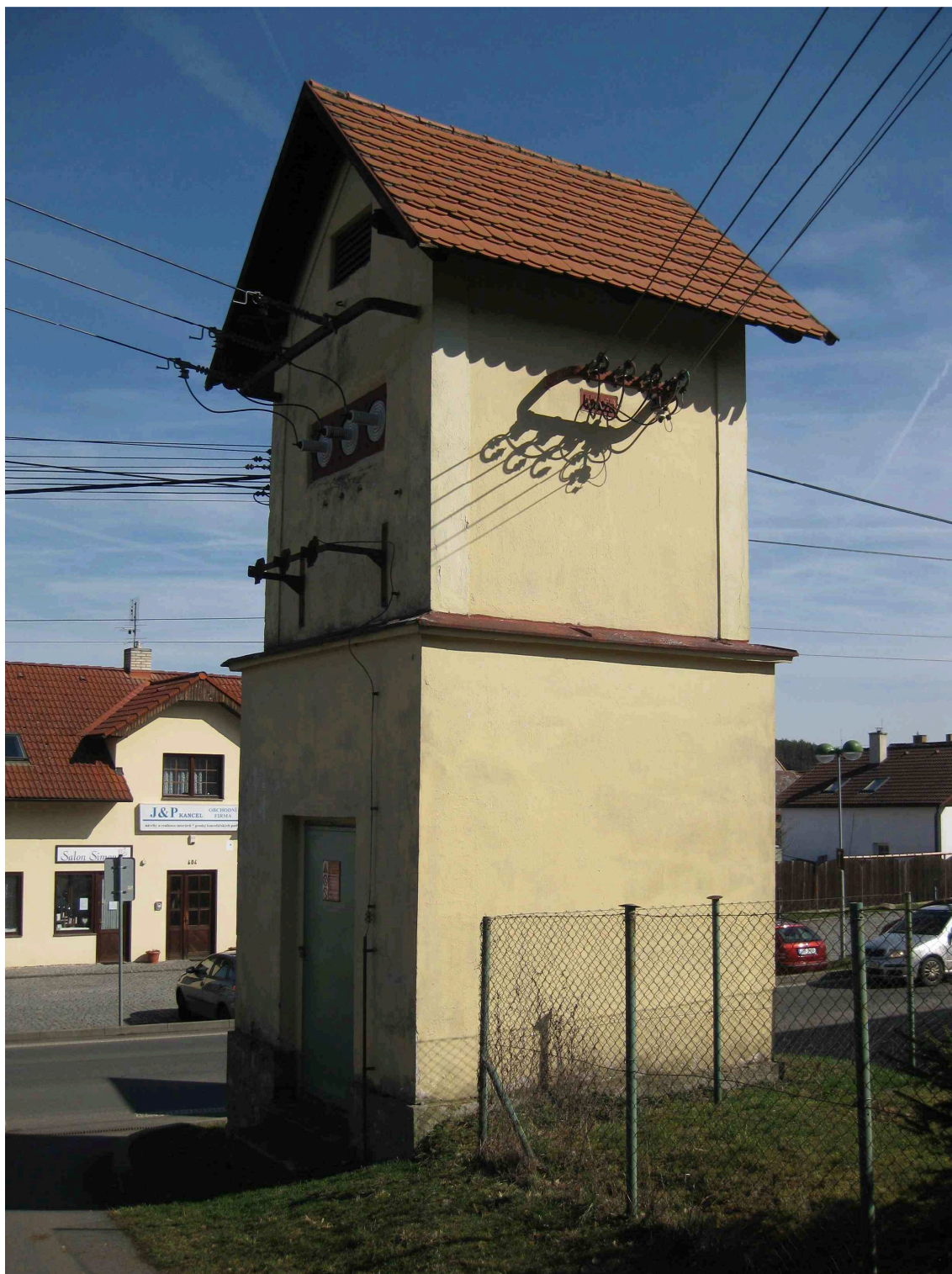
Příloha 56: Dochovaný funkční věžový transformátor v obci Zbiroh. 485 Transformační stanici postavil místní zedník Jaromír Hájek v roce 1924. 486
