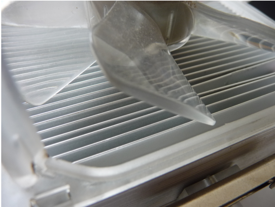
Obrázek č.10 CPU chladič po vyčištění
