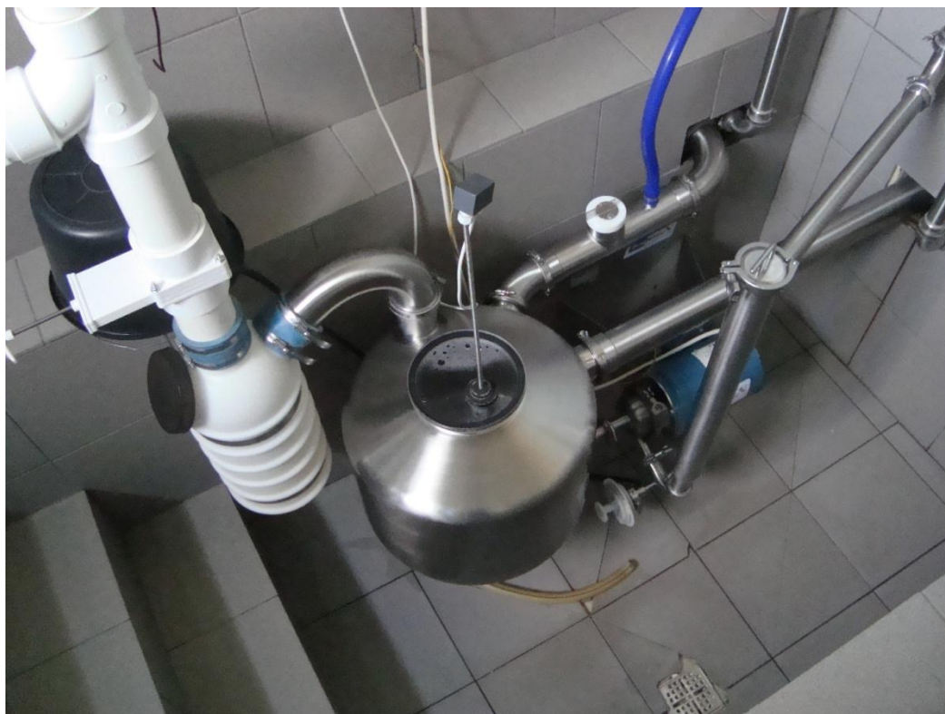
Obr. 1.11 – Sběrná podtlaková nádoba, čerpadlo, mléčné potrubí s vloženým filtrem
