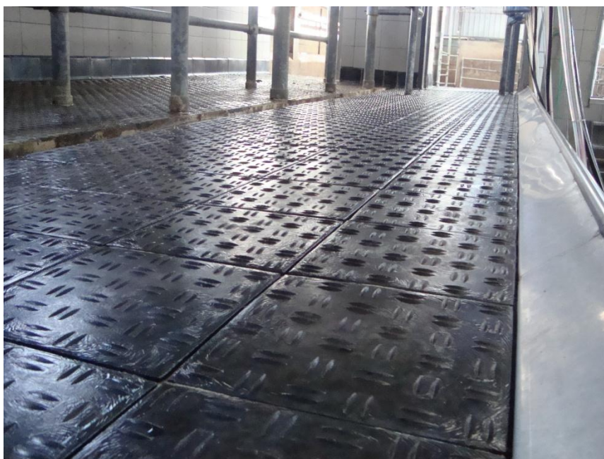
Obr. 1.4 – Čedičová profilovaná dlažba v dojírně a čekárně
