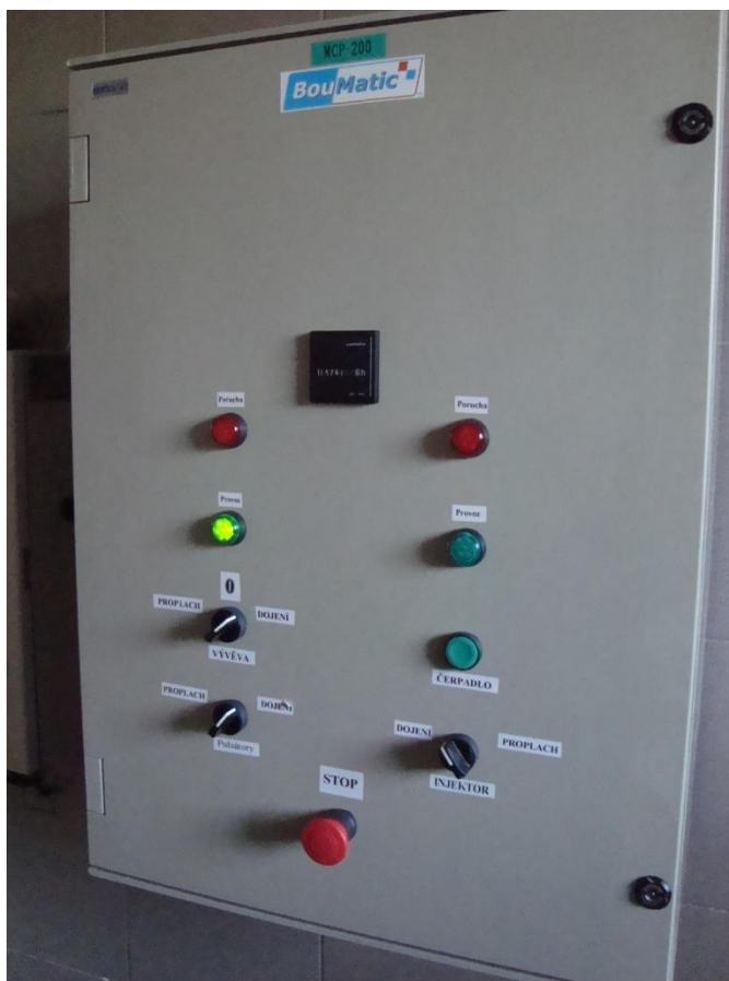
Obr. 1.15 – Hlavní rozvaděč (MCP 200)
