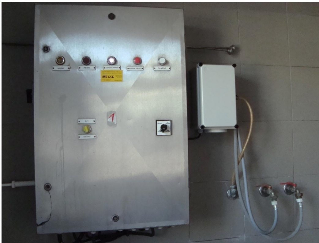
Obr. 1.10 – Rozvaděč s přívodem vody a sanitačního prostředku, Packomat (mléčnice)
