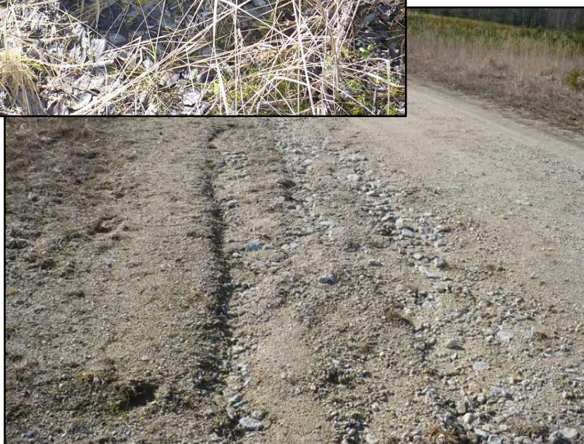
Obr. 26: Eroze na hospodárnících Zdroj: Foto Jan Zábojník
