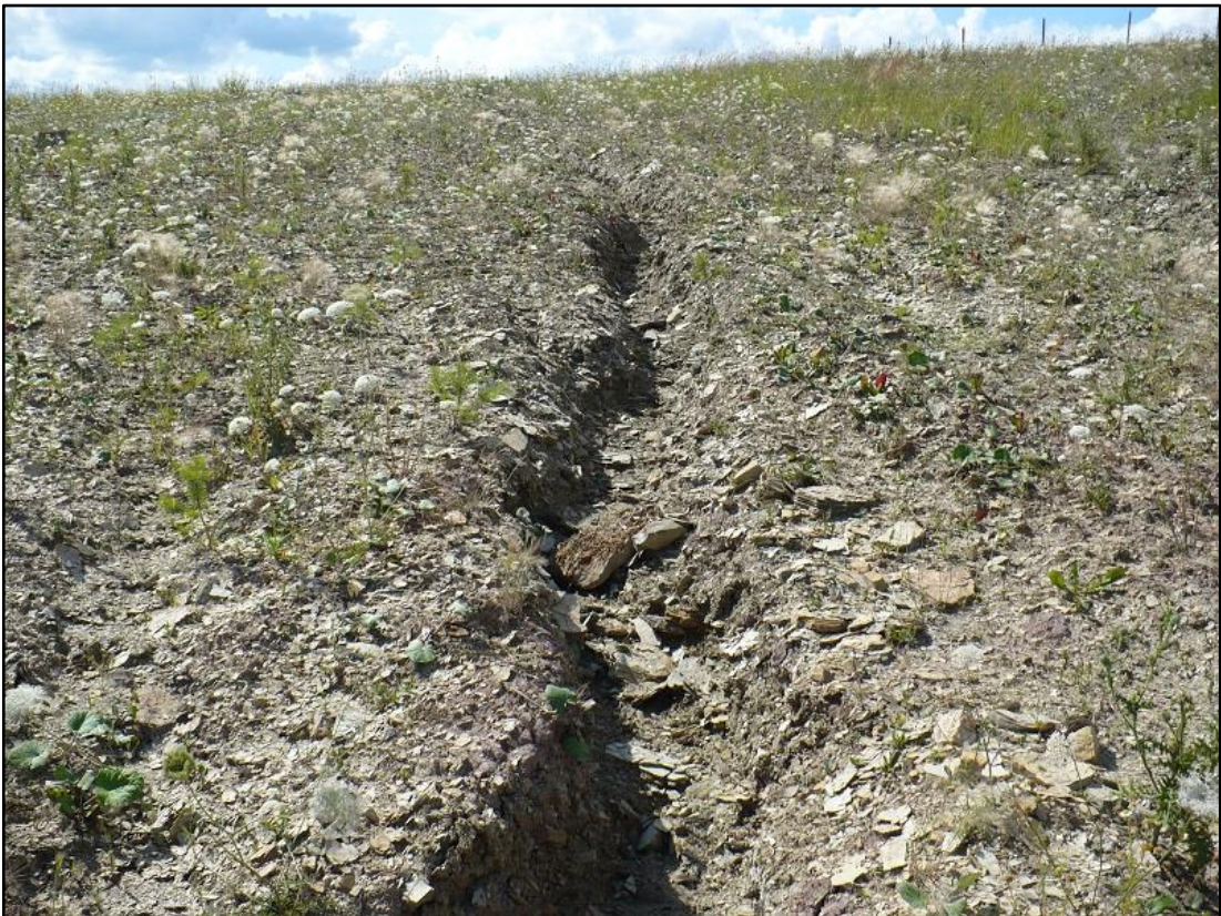
Obr. 7: Projevy eroze na VPV
