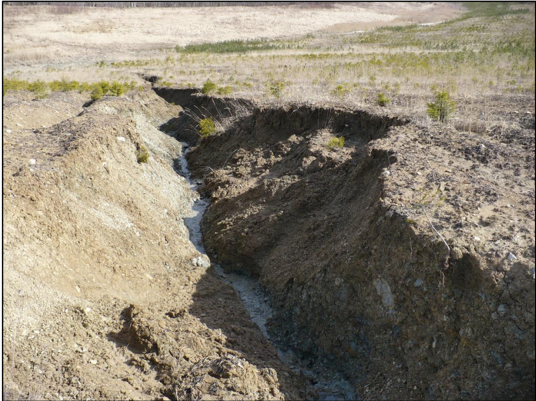
Obr. 8: Projevy eroze na VPV
