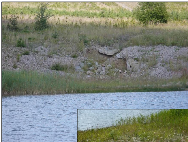
Obr. 23: Vymletý břeh retenční nádrže N2 Zdroj: Foto Jan Zábojník
