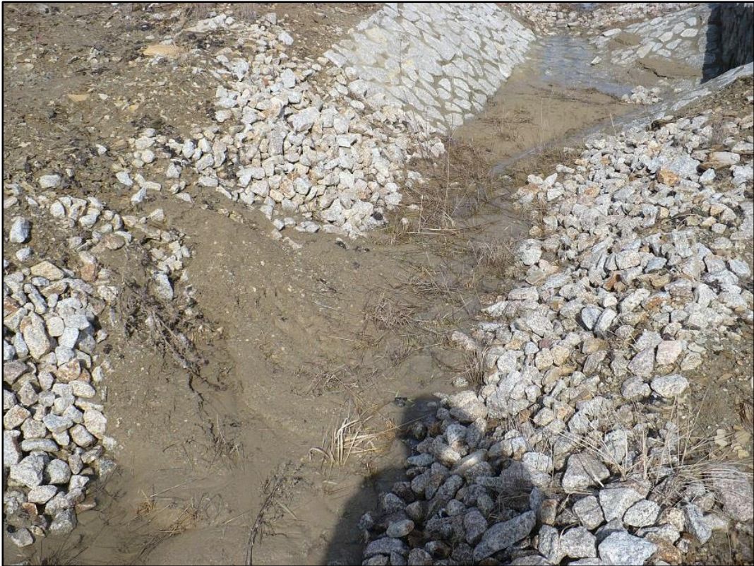
Obr. 22: Zanešení lichoběžníkového koryta
