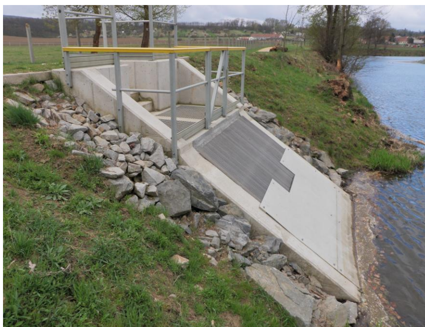
Obr. 4.4 Boční odběrný objekt s jemnými česli a dodatečně osazeným kompozitem
