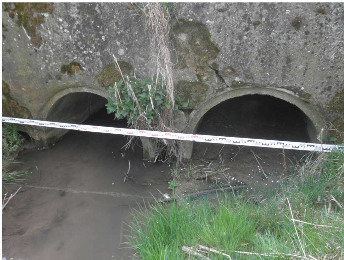
Obr. 27: Narušení mostu ř. km 11,047 [12].
