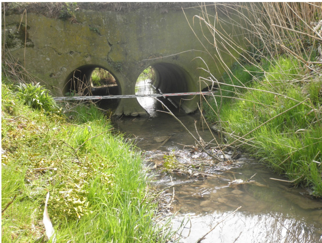
Obr. 28: Technický stav mostu ř. km 11,355 [12].
