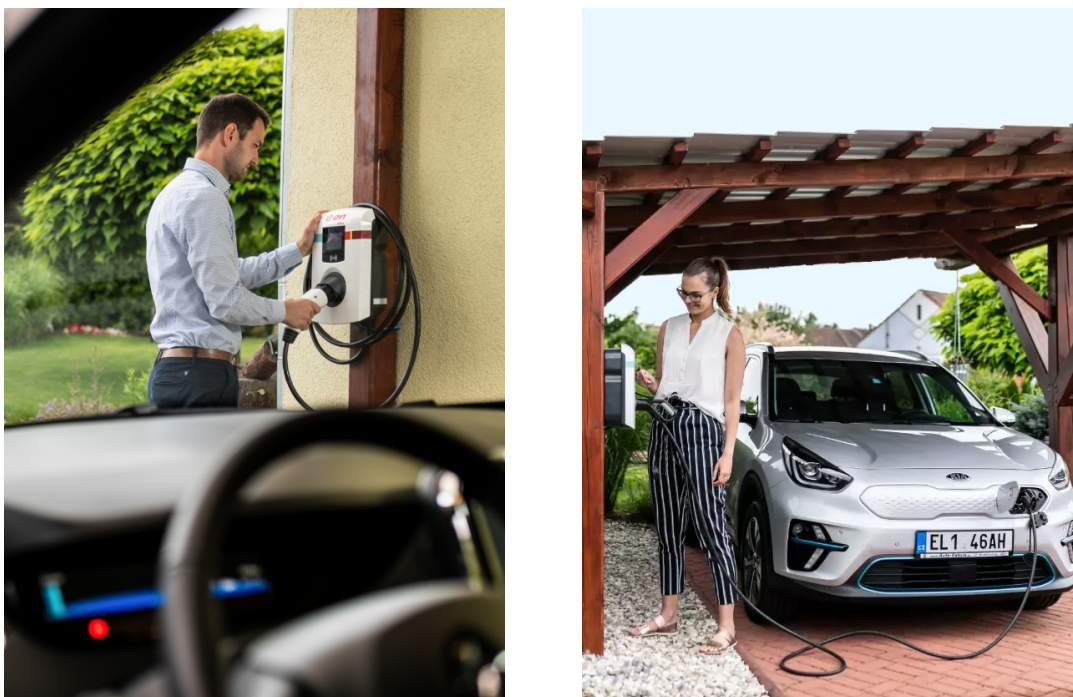
Obr. 2.4: Soukromá dobíjecí stanice [64]
