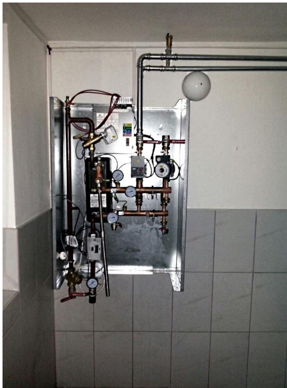
Předávací stanice tepla Systherm (Autor, prosinec 2014)
