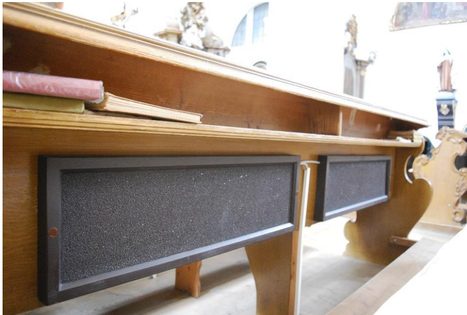
Obr. 22 Sálavé elektrické panely v kostole Jména Ježíš [3]
