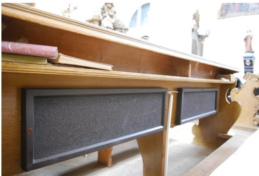
Obr. 22 Sálavé elektrické panely v kostole Jména Ježíš [3]
