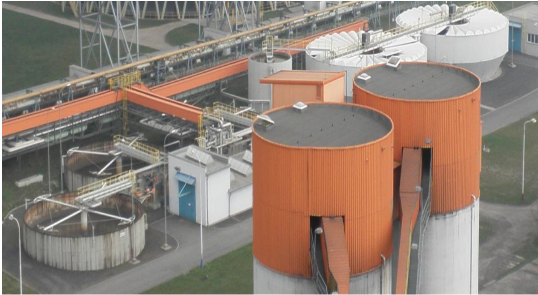
Foto č. 3: Čistírna odpadních vod (Kantorová, 2014).
