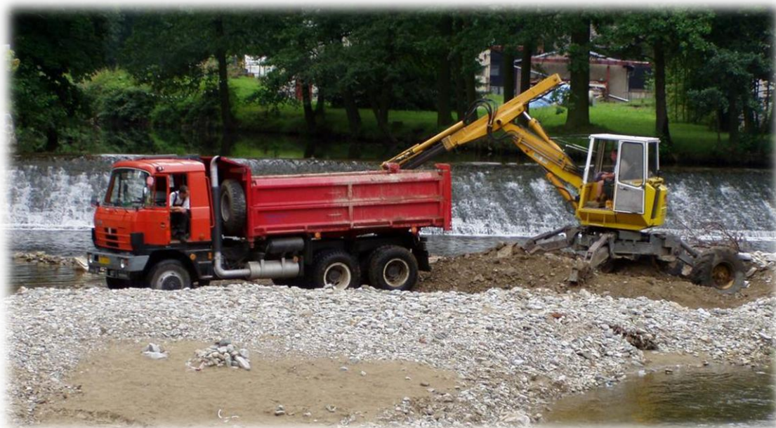
Obrázek 17: Kráčející rýpadlo po povodni pod jezem Volyňka
