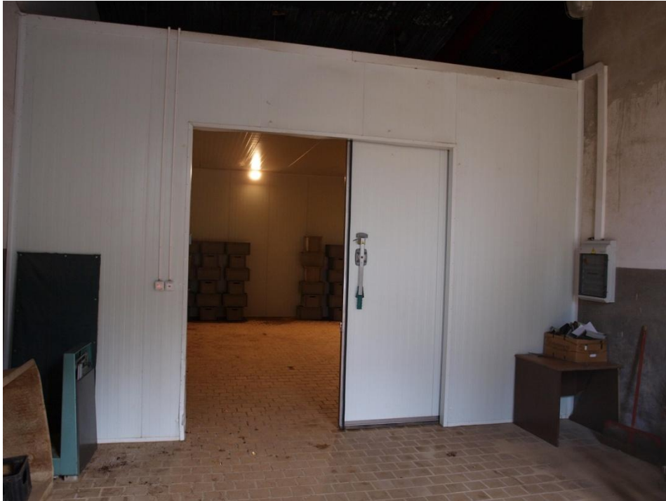
Obr. č. 4 Klimatizovaný sklad
