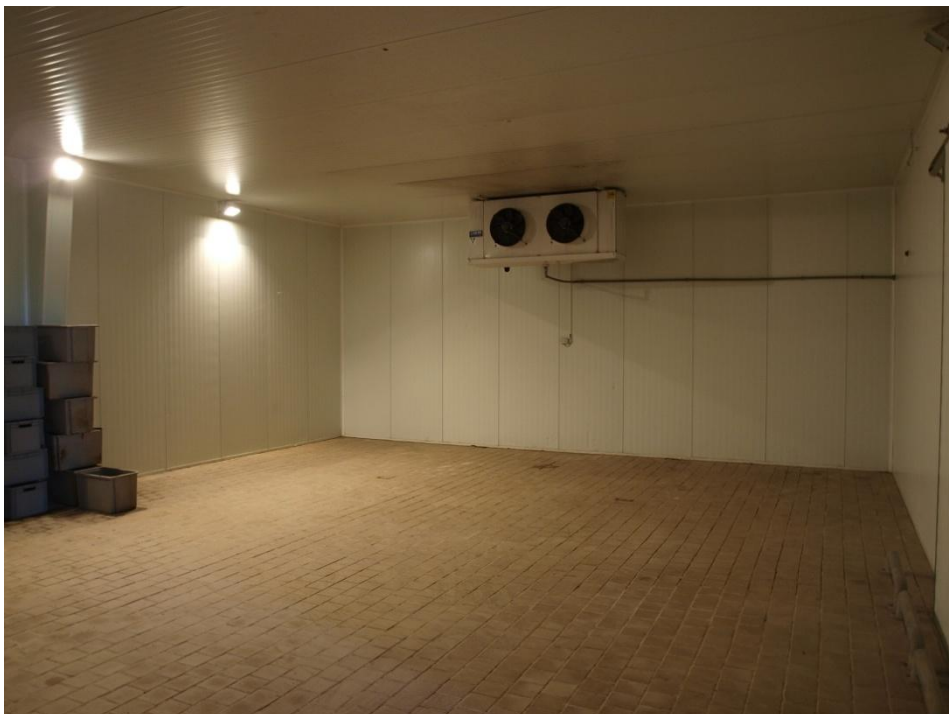
Obr. č. 5 Klimatizovaný sklad
