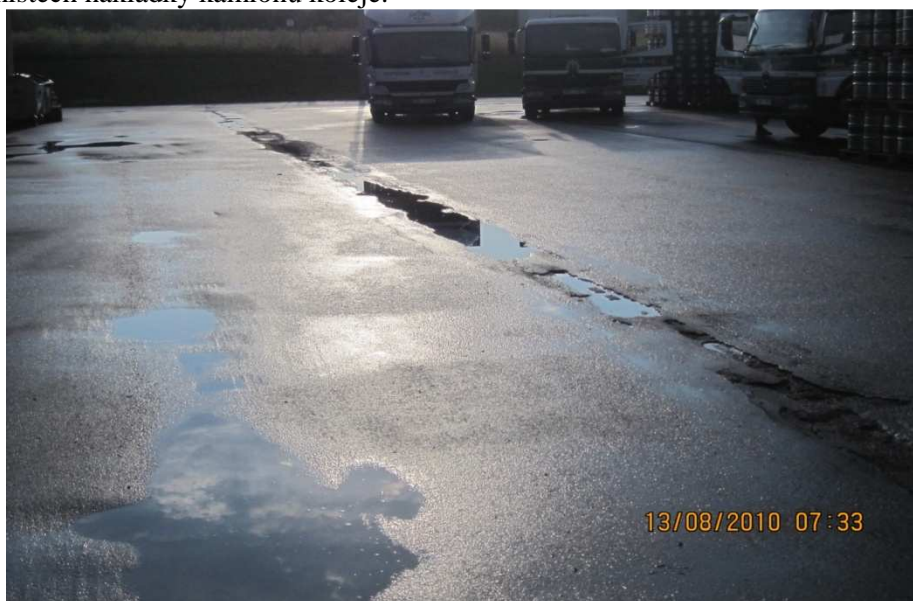
Obrázek 47: Náhled na poškozený povrch
