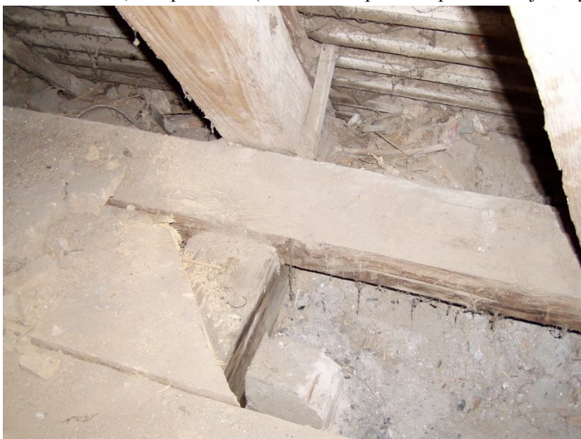
Obr. 3.2.1 Porušenie väzného trámu
