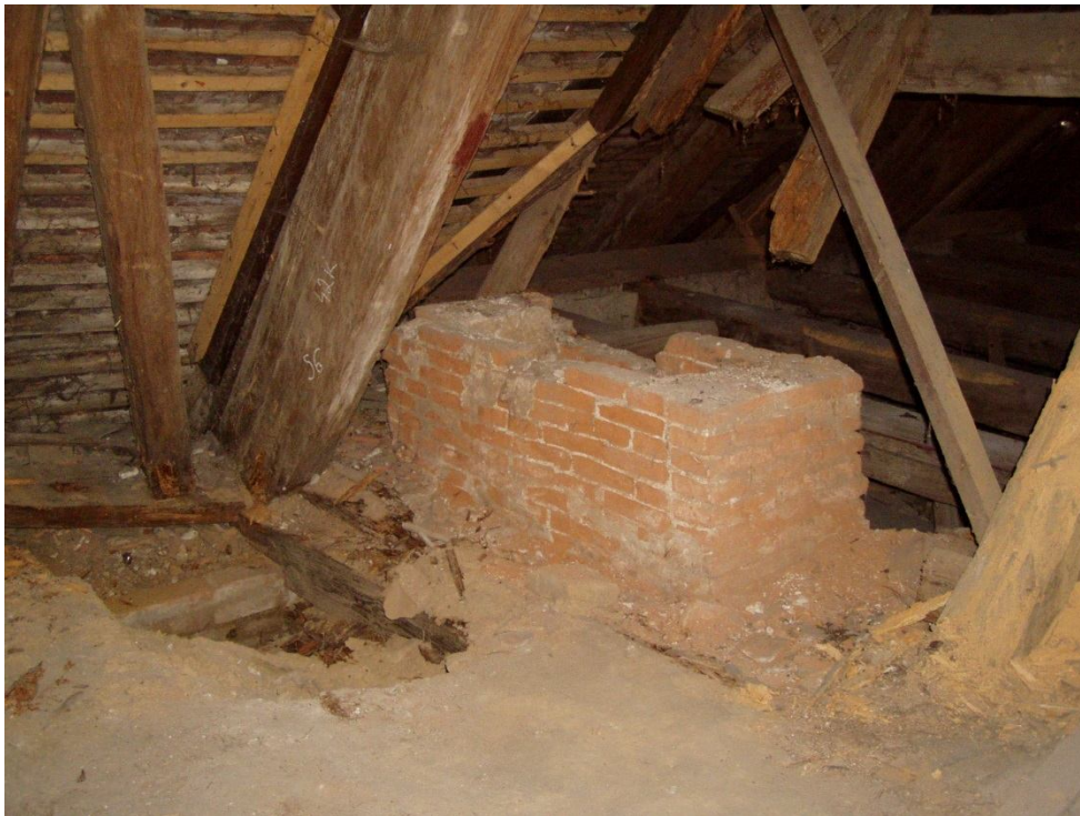
Obr. 3.2.2 Porušenie nosných prvkov krovu
