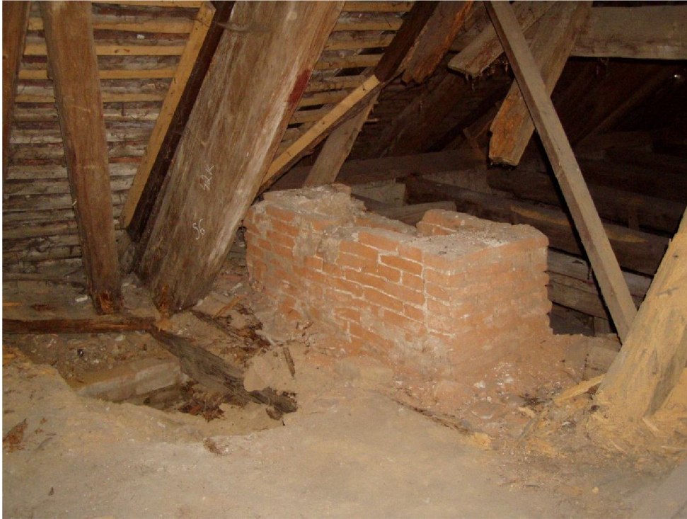
Obr. 3.2.2 Porušenie nosných prvkov krovu
