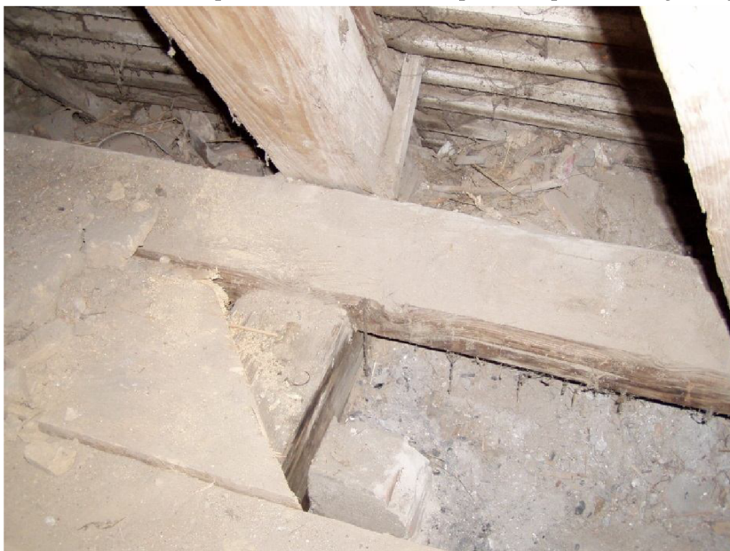
Obr. 3.2.1 Porušenie väzného trámu
