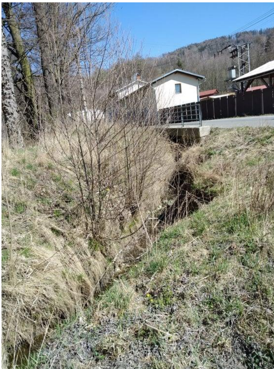
Odpadní kanál z bývalé strojírny a pily v Bohdíkově (foto: Jakub Morong 4. 4. 2020)
