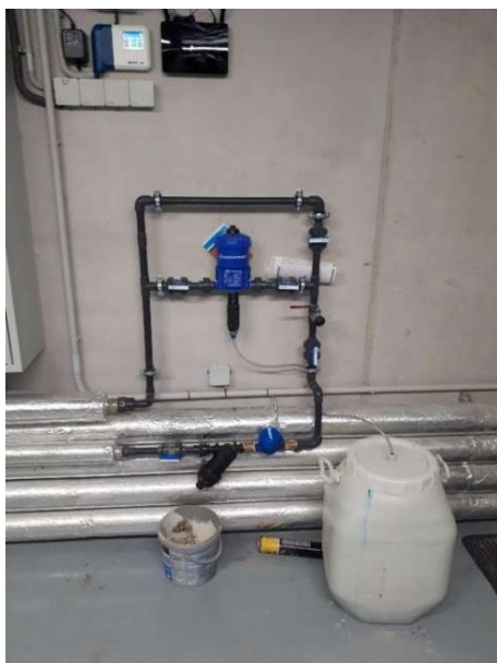
Obr. 5-68: Uzavřený zavlažovací systém umístěný v suterénu KVOP [36]
