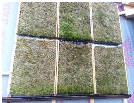
Obr. 5-10: Růst mechu pouze ve spodních částech zavlažovaných panelů
