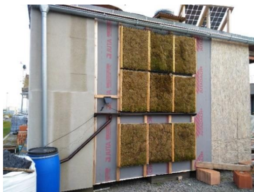
Obr. 5-9: Mechové panely instalované na testovacím objektu v Centru AdMaS, 09/2017
