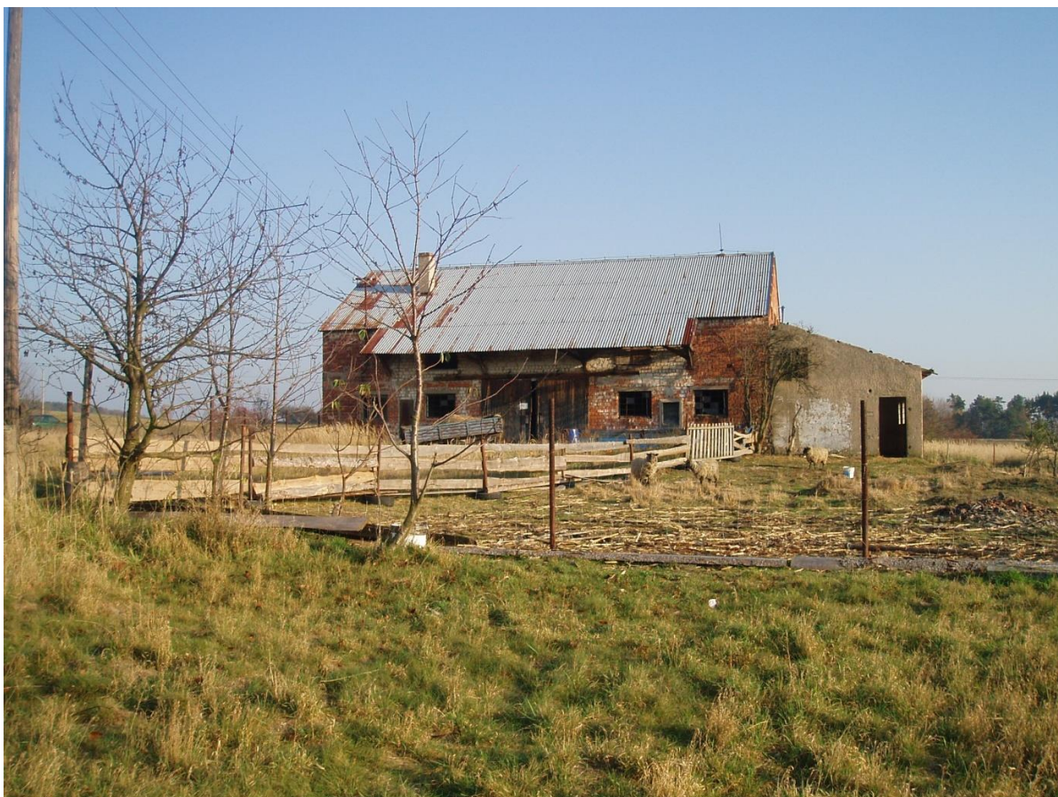
Obrázek 20.: Bývalý kravín, obec Rasochy (Středočeský kraj). Objekt je využit jen z velmi malé části a bez větších stavebních úprav, proto nadále chátrá. FOTO: Slaninková, 2011
