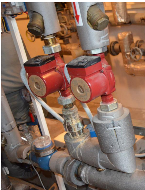
Foto 4 Čerpadlo s plynulou regulací otáček na vratném potrubí UT vlevo a čerpadla na cirkulaci TV s tří stupňovou regulací otáček vpravo
