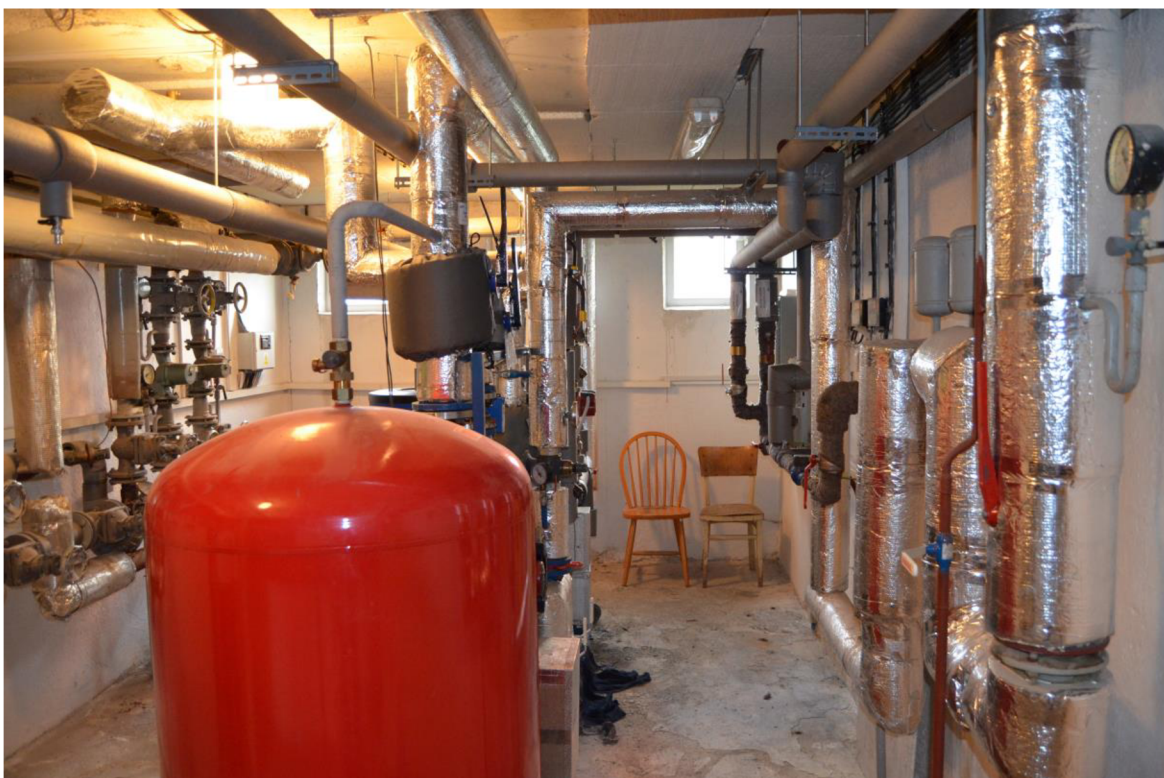
Foto 2 Domovní předávací stanice Svážná 1
