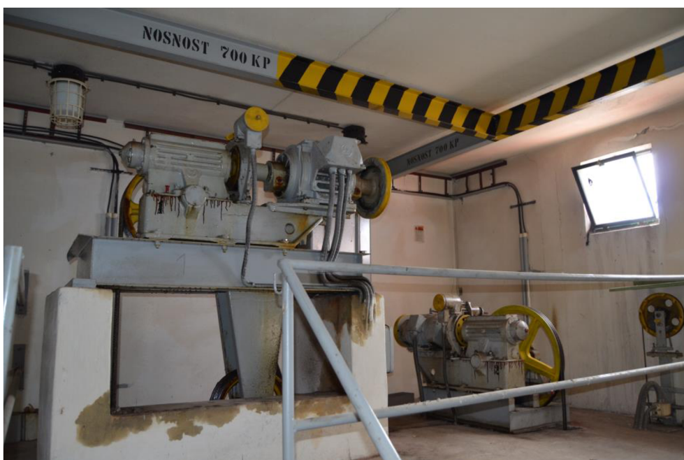
Foto 5 Strojovna výtahů na střeše objektu
