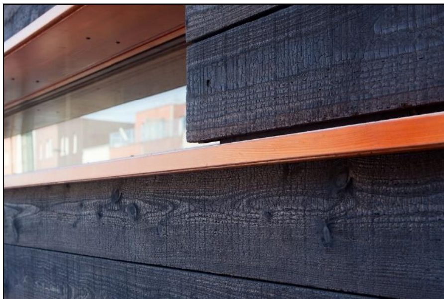
Obr. 46 Pohled na opálená fasádní prkna (Profispeciál, 2012)
