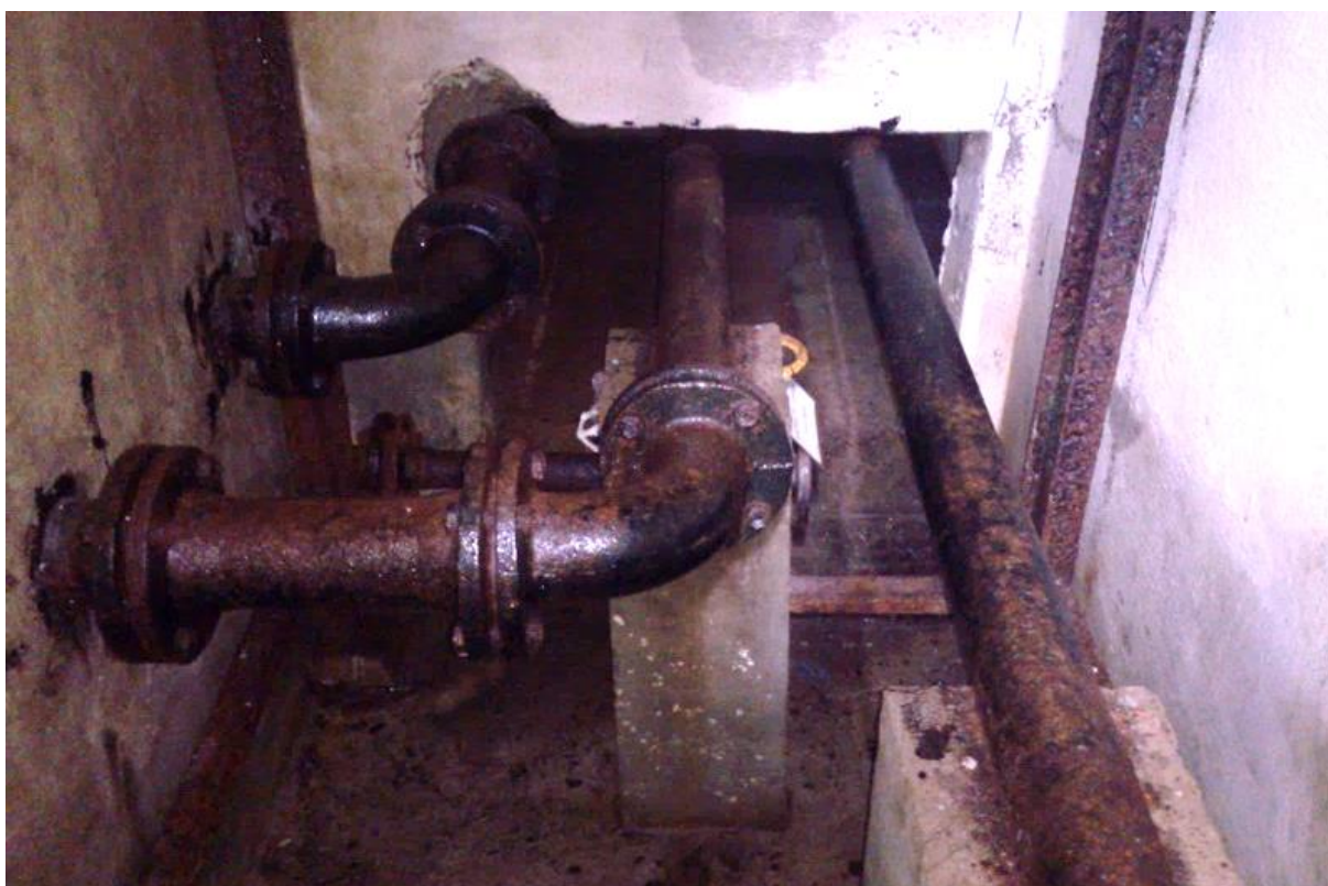
Obrázek 5.3 Pohled na potrubí z akumulace ČS1-BOR
