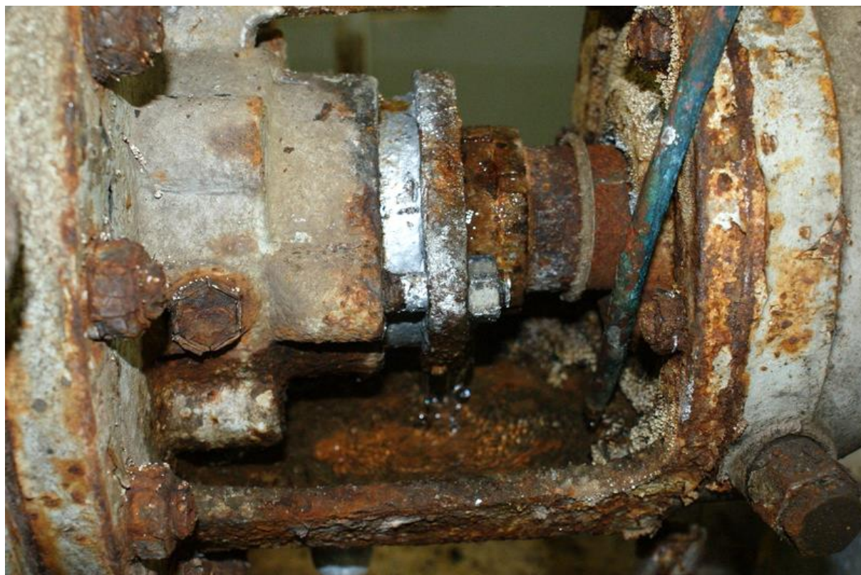
Obrázek 5.6 Detail spoje motor-čerpadlo na čerpací stanici ČS2-HRAD
