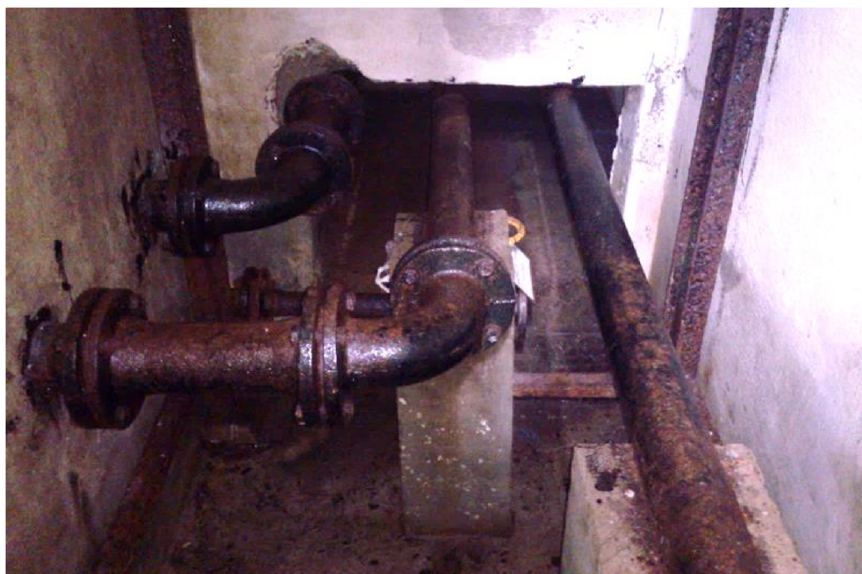
Obrázek 5.3 Pohled na potrubí z akumulace ČS1-BOR
