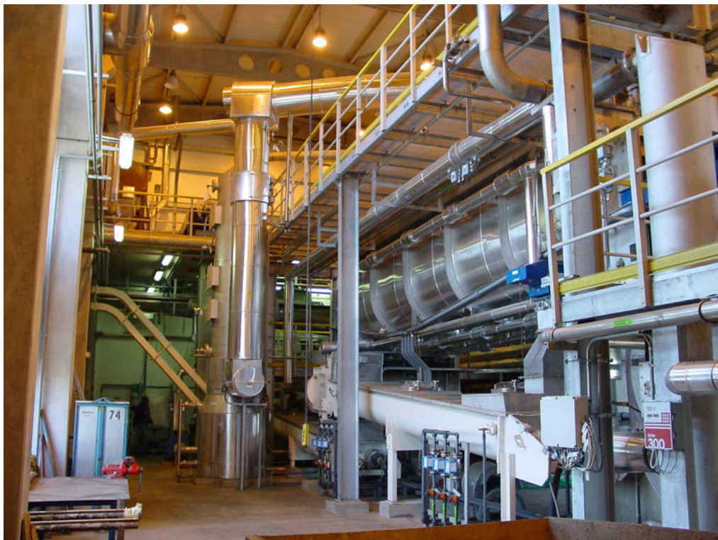
Obr. 12 Disková sušárna odvodněných kalů ČOV Modřice [26]
