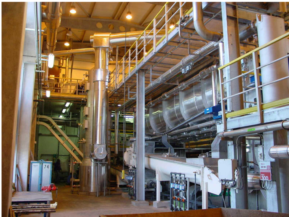
Obr. 12 Disková sušárna odvodněných kalů ČOV Modřice [26]
