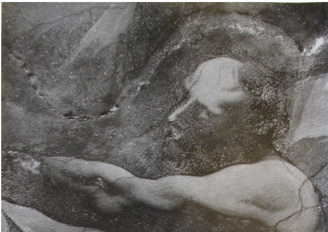
Obrázek 4: Josef Winterhalder ml., nástěnná malba klenby, 1770, kostel Nanebevzetí Panny Marie, Brno – Zábřdovice .Detail poškození plísněmi a trhlinami. Foto: NPÚ ÚOP Brno.
