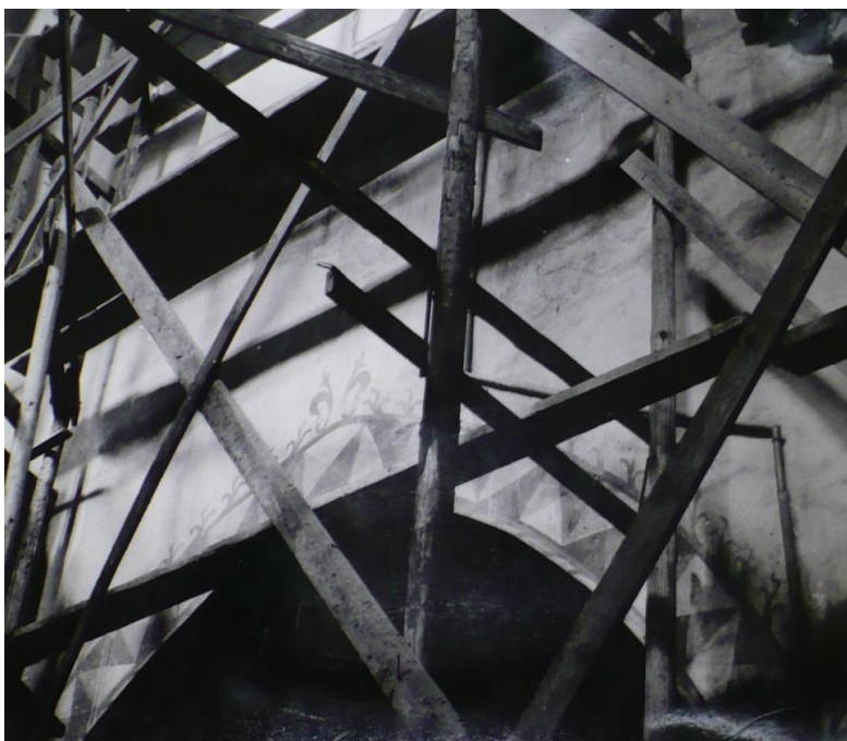
Obrázek 55: Jihlava, kostel Nanebevzetí Panny Marie, okolo 1240, čelní stěna vítězného oblouku. Pohled na pracovní lešení a pozdně gotickou diamantovou rustiku. Foto: NPÚ ÚOP Telč.
