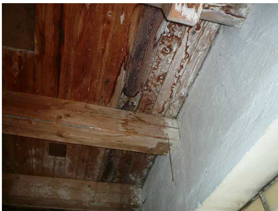
Obrázek 25: Skvrny od zatékání
