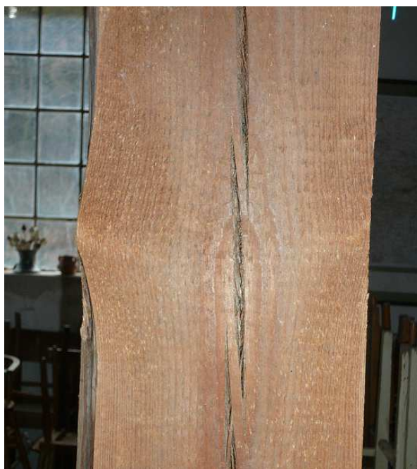
Obrázek 23: Výsušná trhlina u sloupu č. 1
