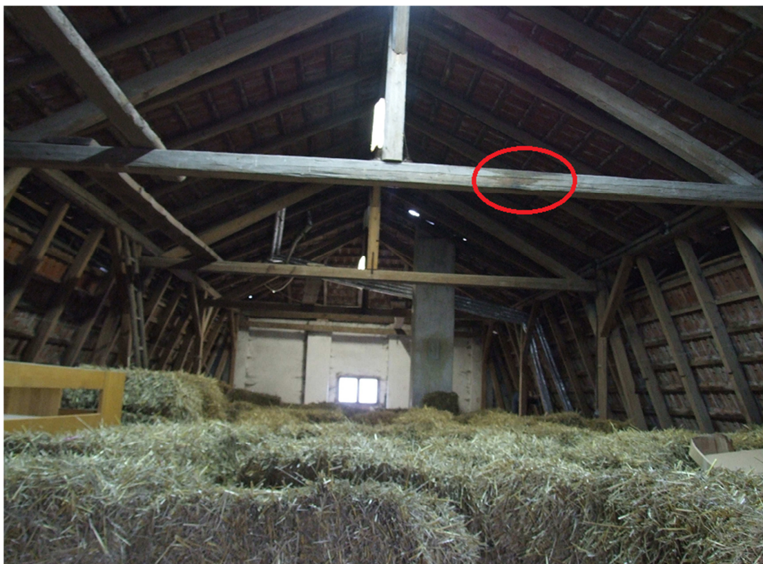
Obrázek 26: Skvrna od zatékání
