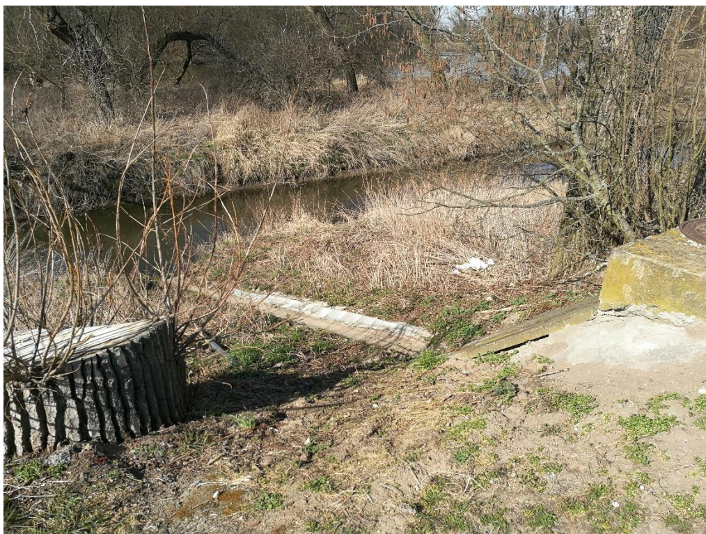
Vyústění z ČOV do recipientu (vlastní zdroj)
