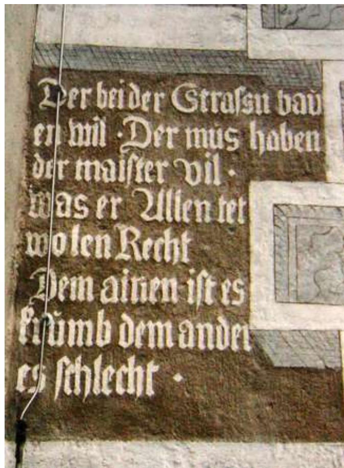
Obr. 125 Nápis na boku rizalitu sgrafitové fasády Staré radnice, Zwettl [Zdroj: Archiv restaurátorských zpráv, RZ 3040AB, Václav Špale, Restaurování fasády domu čp.518, 2004 ]
