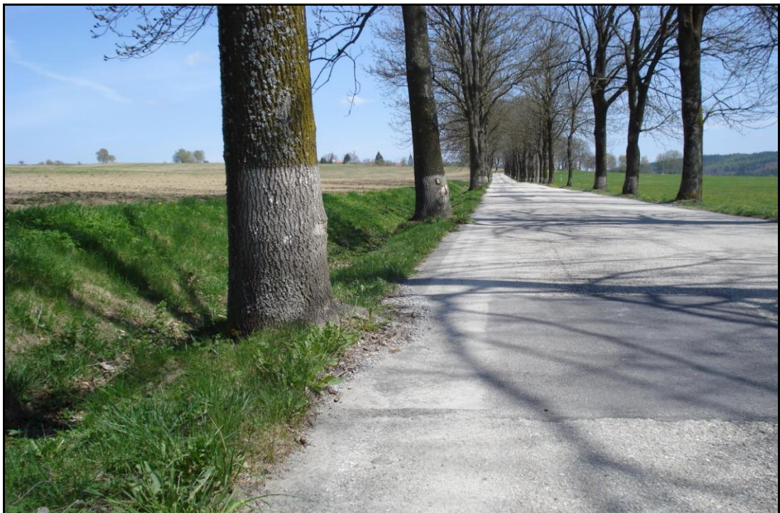
Bližší pohled na narušování okrajů vozovky od kořenových systémů vzrostlých stromů na sil. č. II/157 před obcí Besednice.
