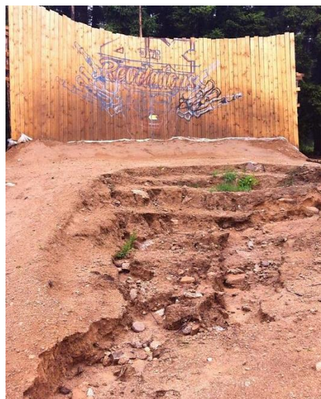
Obrázek 21: Poškozená trať vodní erozí (JBC 4X Revolutions)
