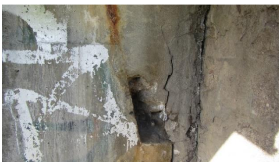
Obrázek 20: Pohled na odtrženou dobetonávku kotev od čela nosníků [foto J. Láník]
