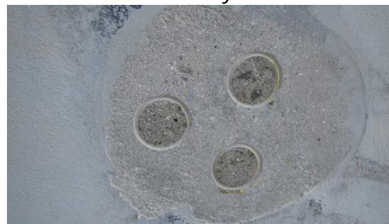
Obrázek 112: Pohled na zkušební místo PS11 po provedení odtrhové zkoušky
