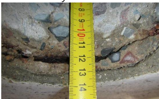
Obrázek 147: Pohled na porušení betonu dobetonávky VS2.9-2.10
