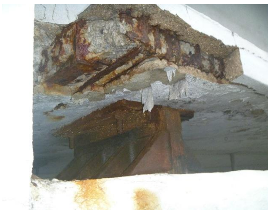
Obrázek 47: Pohled na zkorodované pevné ložisko I.P.4 u Brněnské opěry, na detailu je dále vidět chybějící část příruby nosníku I-73
