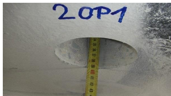
Obrázek 64: Detailní foto měření hloubky vývrtu V2OP1
