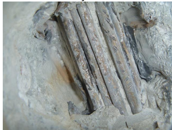
Obrázek 168: Detailní pohled na stav předpínacích drátů sondy K2.7
