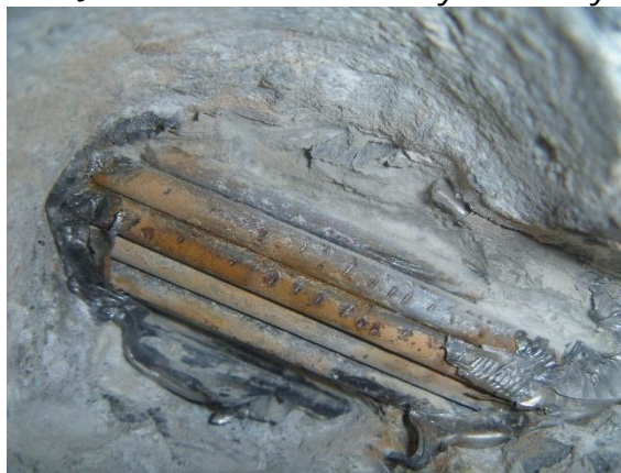
Obrázek 164: Detailní pohled na stav předpínacích drátů sondy K2.5
