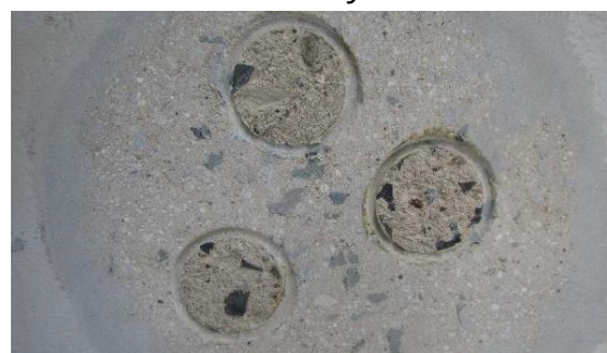
Obrázek 110: Pohled na zkušební místo PS6 po provedení odtrhové zkoušky
