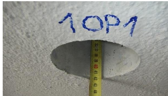
Obrázek 60: Detailní foto měření hloubky vývrtu V1OP1
