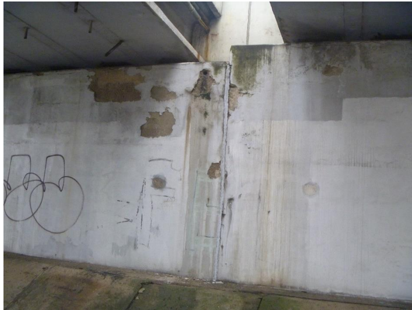
Obrázek 41: Pohled na část Brněnské opěry. Viditelné zmáčení opěry v okolí dilatace a poškození povrchu opěry a úložných prahů
