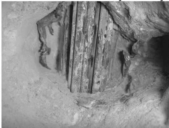
Obrázek 183: Detailní pohled na stav předpínacích drátů sondy K1.5
