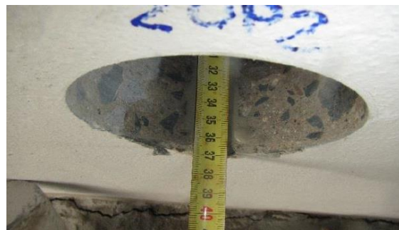
Obrázek 88: Detailní foto měření hloubky vývrtu V2OP2
