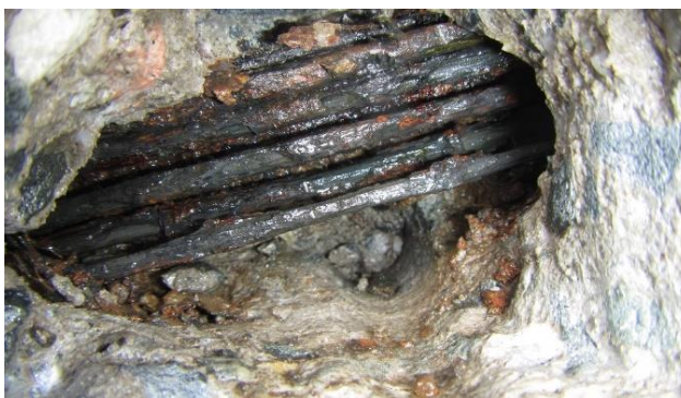
Obrázek 16: Pohled na zkorodované a oslabené předpínací dráty [foto J. Láník]
