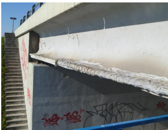
Obrázek 45: Pohled na chybějící část dolní příruby nosníku 1.10
