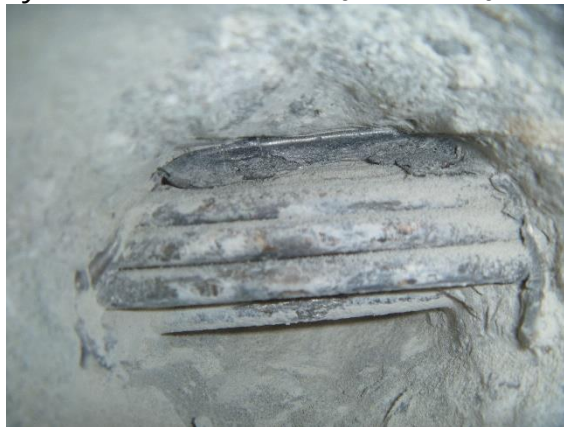
Obrázek 174: Detailní pohled na stav předpínacích drátů sondy K2.10
