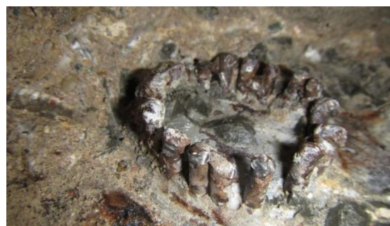
Obrázek 21: Detailní pohled na kotevní oblast s povrchovou korozí kabelů a kotevní desky [foto J. Láník]
