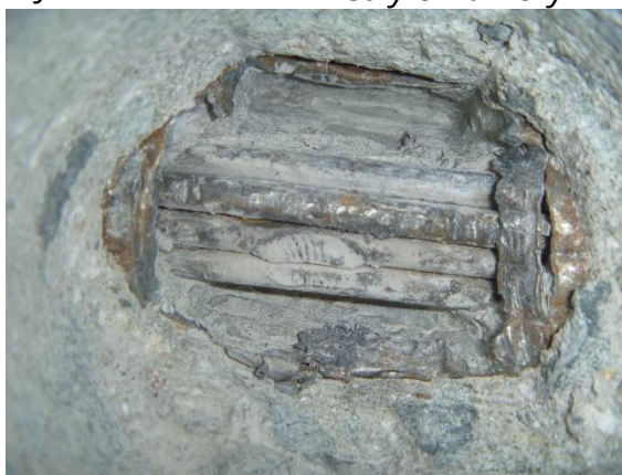
Obrázek 191: Detailní pohled na stav předpínacích drátů sondy K1.9
