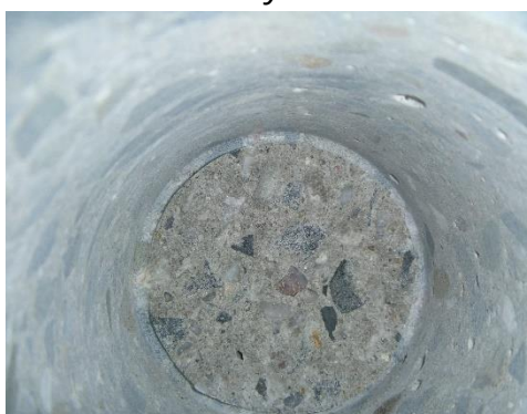
Obrázek 132: Detailní foto ostění vývrtu V2N2.10
