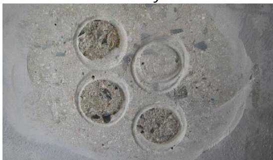
Obrázek 111: Pohled na zkušební místo PS8 po provedení odtrhové zkoušky
