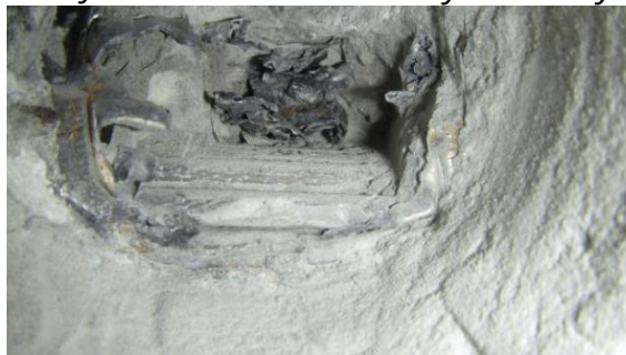
Obrázek 171: Detailní pohled na stav předpínacích drátů sondy K2.9
