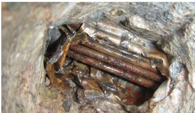
Obrázek 14: Pohled do neproinjektované chráničky [foto J. Láník]
