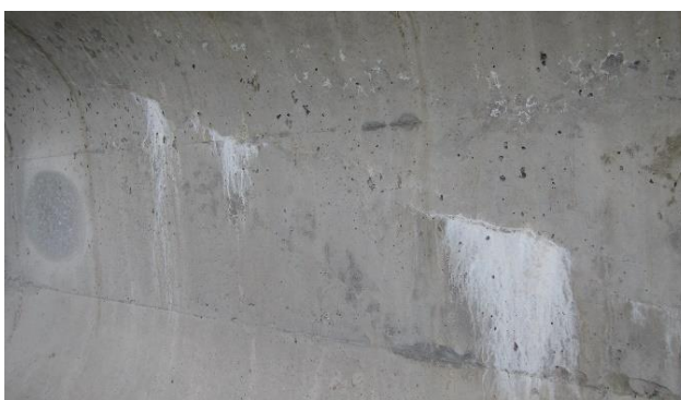
Obrázek 24: Pohled na podélnou trhlinu v místě trasy předpínacího kabelu [foto J. Láník]
