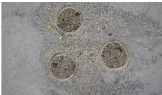
Obrázek 107: Pohled na zkušební místo PS1 po provedení odtrhové zkoušky
