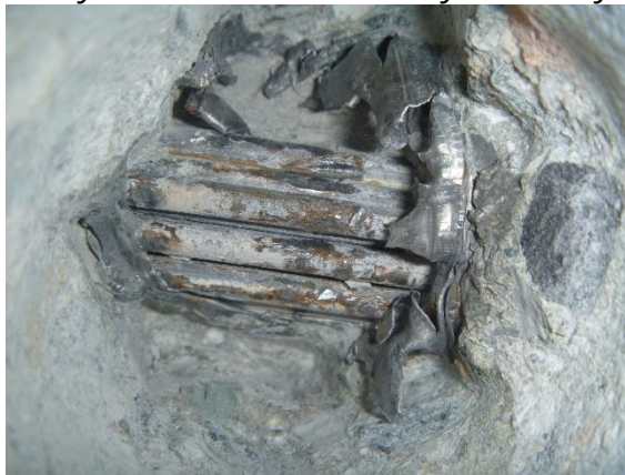
Obrázek 188: Detailní pohled na stav předpínacích drátů sondy K1.9
