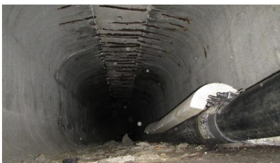
Obrázek 18: Pohled do dutiny na korozi výztuže dobetonávky na horním povrchu nosníků [foto J. Láník]
