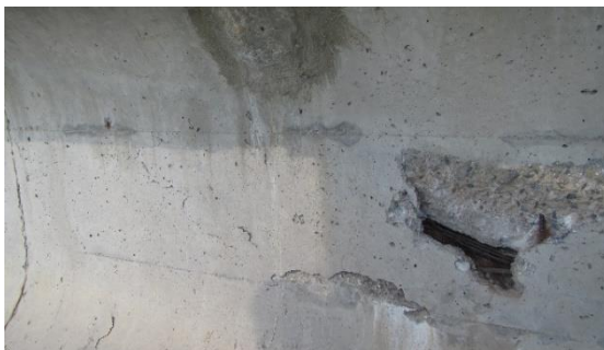
Obrázek 22: Pohled na vymrzlou a odtrženou krycí vrstvu kabelu [foto J. Láník]
