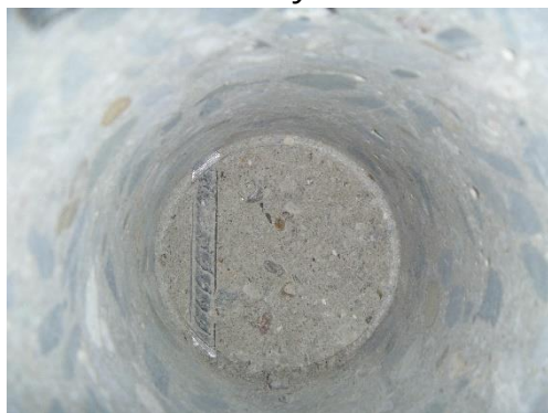
Obrázek 124: Detailní foto ostění vývrtu V2N1.1
