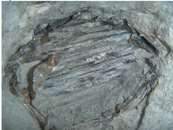
Obrázek 158: Detailní pohled na stav předpínacích drátů sondy K2.1
