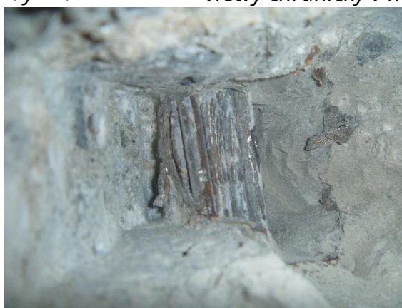
Obrázek 177: Detailní pohled na stav předpínacích drátů sondy K1.1
