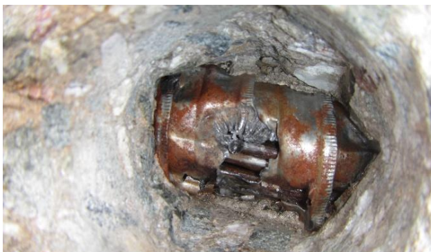
Obrázek 12: Pohled na zkorodovanou ocelovou chráničku [foto J. Láník]
