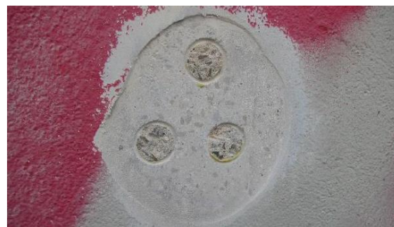
Obrázek 108: Pohled na zkušební místo PS10 po provedení odtrhové zkoušky
