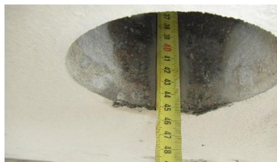
Obrázek 100: Detailní foto měření hloubky vývrtu VK3
