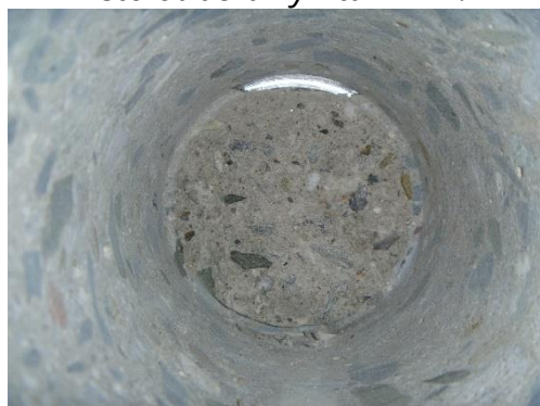
Obrázek 120: Detailní foto ostění vývrtu V1N1.1
