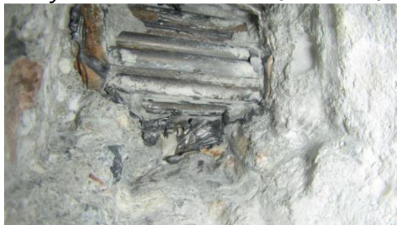
Obrázek 180: Detailní pohled na stav předpínacích drátů sondy K1.2
