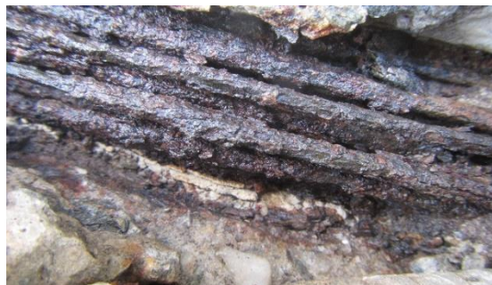
Obrázek 23: Detailní pohled na stav předpínací výztuže v místě odtržené krycí vrstvy [foto J. Láník]
