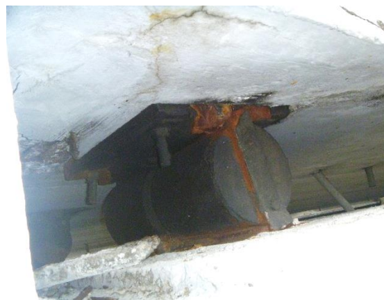
Obrázek 48: Pohled na mírně zkorodované pohyblivé ložisko I.V.4 u Ostravské opěry
