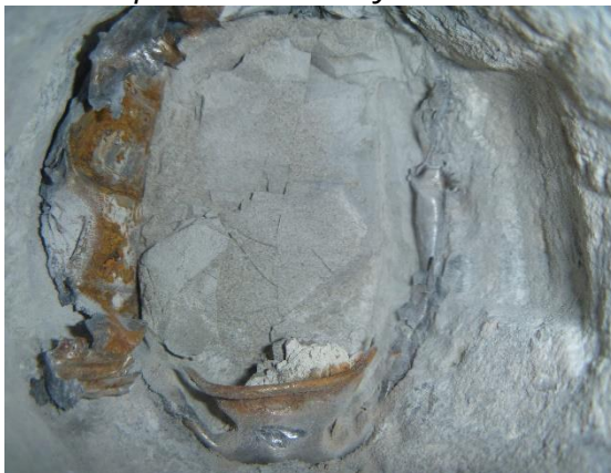
Obrázek 167: Detail stavu proinjektování sondy K2.7
