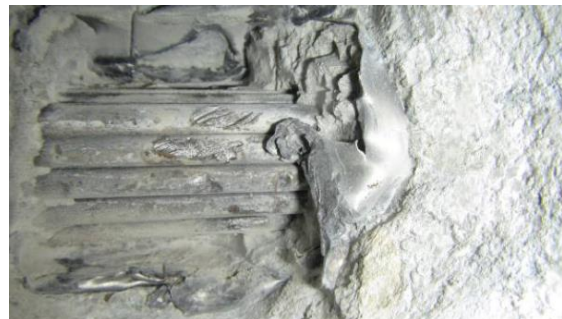
Obrázek 185: Detailní pohled na stav předpínacích drátů sondy K1.7
