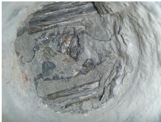
Obrázek 161: Detailní pohled na stav předpínacích drátů sondy K2.3
