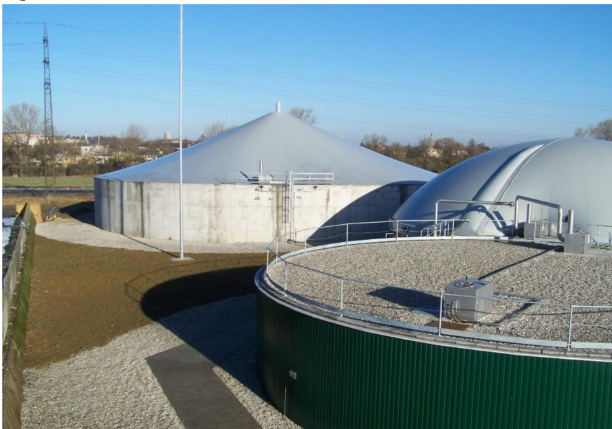
obr. 1: Zemědělská bioplynová stanice Kylešovice [19]
