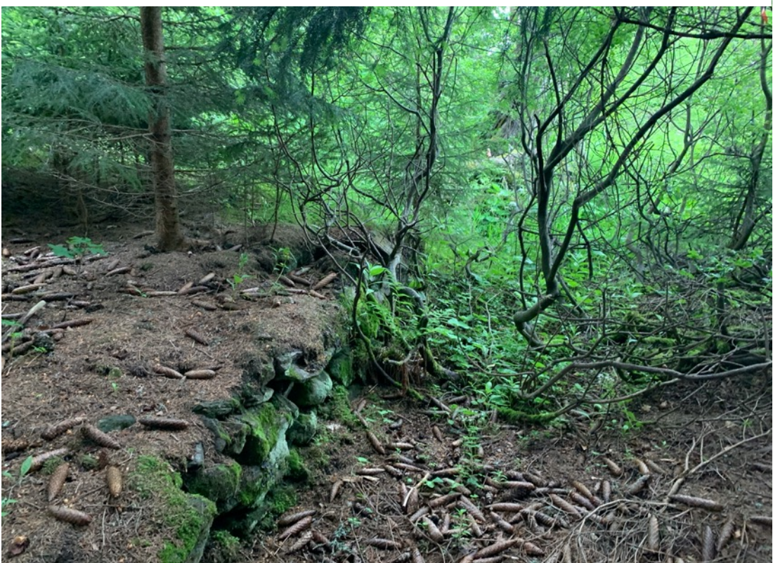
Obr. č. 68 Část odtoku porostlá vegetací (zdroj: vlastní)
