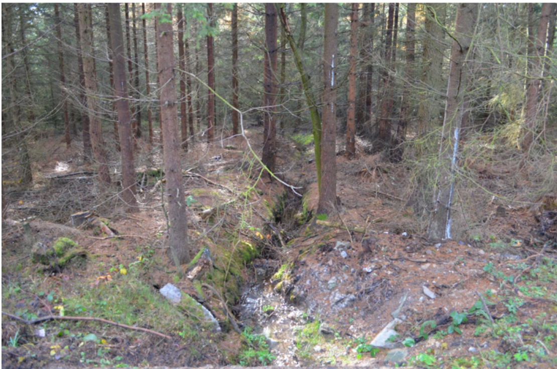
Příloha č. 4 – Aktivní odvodňovací příkop, kde je potřeba údržba, Padrt'ské rybníky (Zdroj: Autor)
