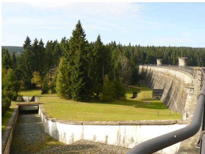
Obrázek 11. Přehradní hráz a bezpečnostní přeliv nádrže Bedřichov.
