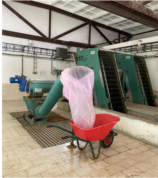
Obr. 8: Jemně strojně stírané česle se šnekovým dopravníkem (zdroj: vlastní).
