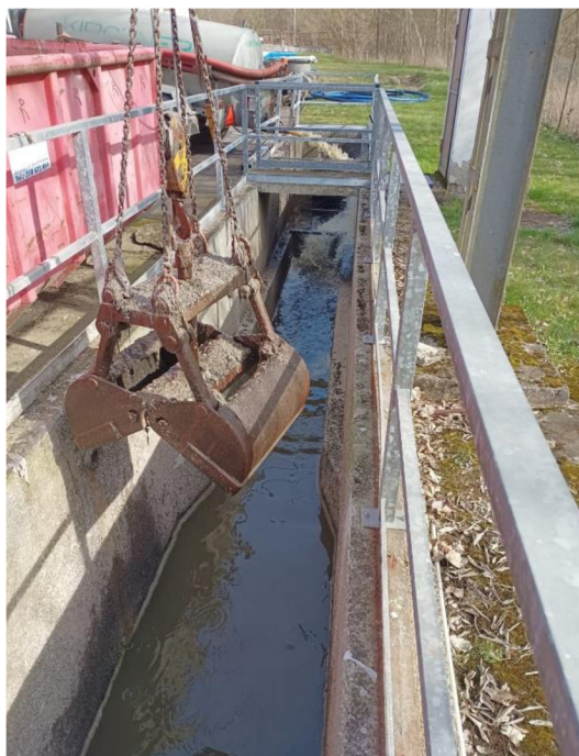
Obr. 7: Nátokový žlab (zdroj: vlastní).
