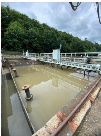
Obr. 13: Usazovací nádrž (zdroj: vlastní).
