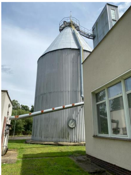
Obr. 24: Vyhňivací nádrž (zdroj:vlastní).
