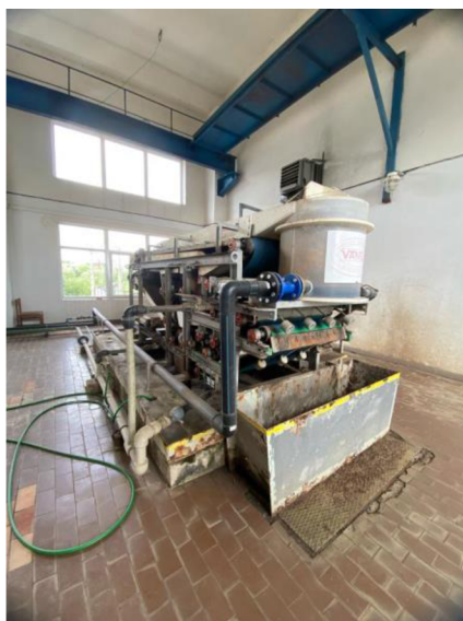
Obr. 26: Odvodňovací lis (zdroj: vlastní).
