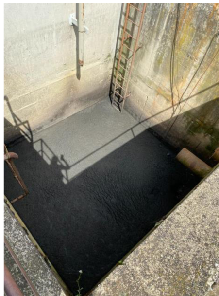
Obr. 23: Kalová jímka (zdroj: vlastní).
