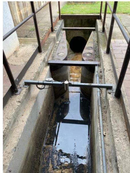
Obr. 12: Měrný objekt s ultrazvukovým snímačem před dešťovou zdrží (zdroj: vlastní).
