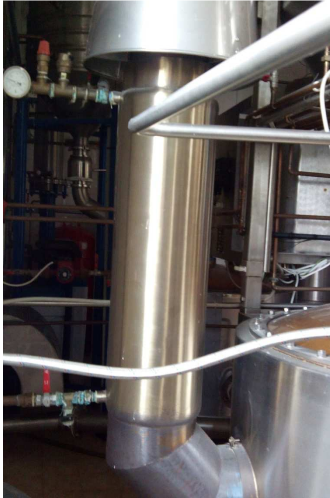
Obrázek 2: Tepelný výměník na komíně
