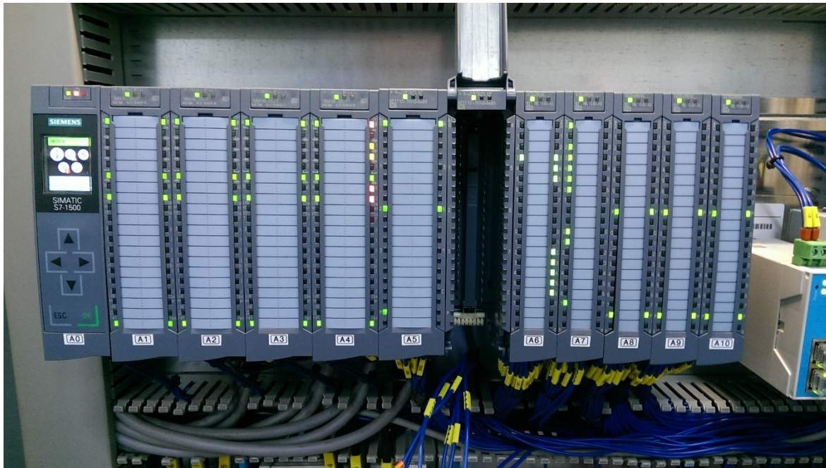
Obrázek 2: Modulární PLC z provozu
