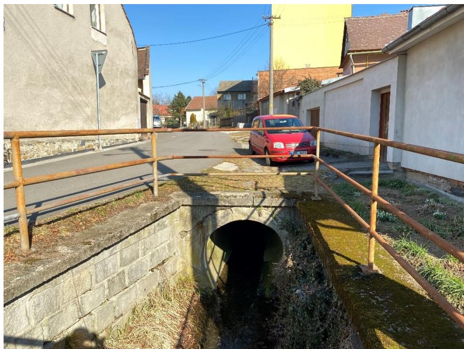
Obr. 25: Vodní tok Loučka veden pod zemským povrchem v městě Lipník nad Bečvou, 2. 3. 2022; vlastní snímek
