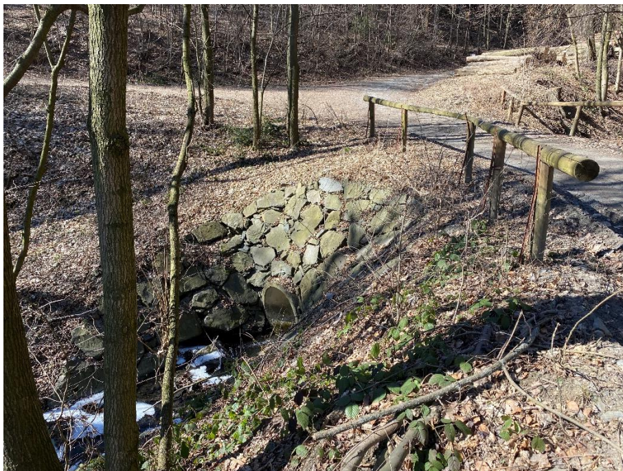
Obr. 34: Vodní tok Žabník veden potrubím pod lesní cestou, 13. 3. 2022, vlastní snímek
