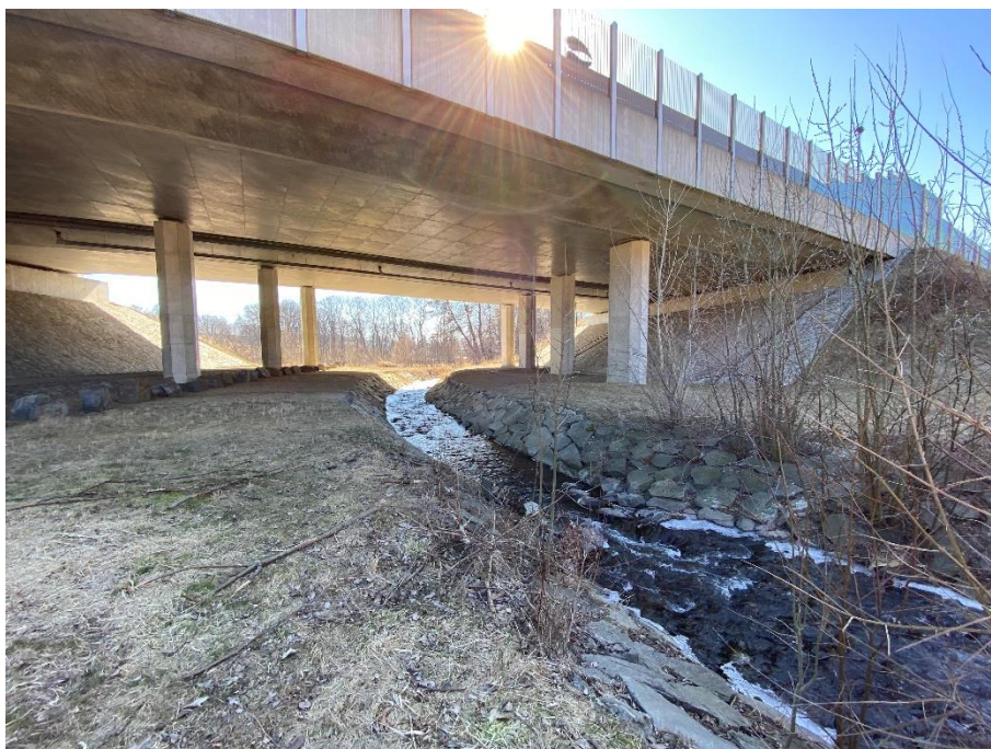
Obr. 32: Vodní tok Jezernice vedený umělým korytem pod dálnicí D1, 13. 3. 2022; vlastní snímek
