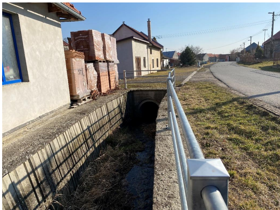
Obr. 24: Vodní tok loučka veden v betonovém korytě dále pod zemským povrchem v městské části Loučka, 2. 3. 2022; vlastní snímek
