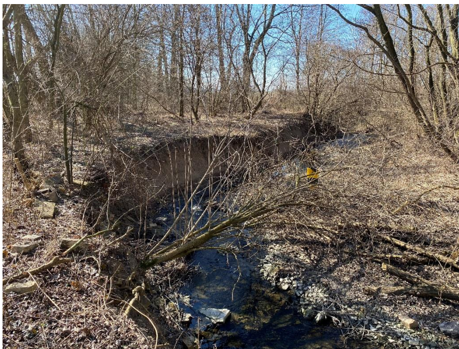
Obr. 4: Břehová nátrž na vodním toku Trnávka, 13. 3. 2022; vlastní snímek
