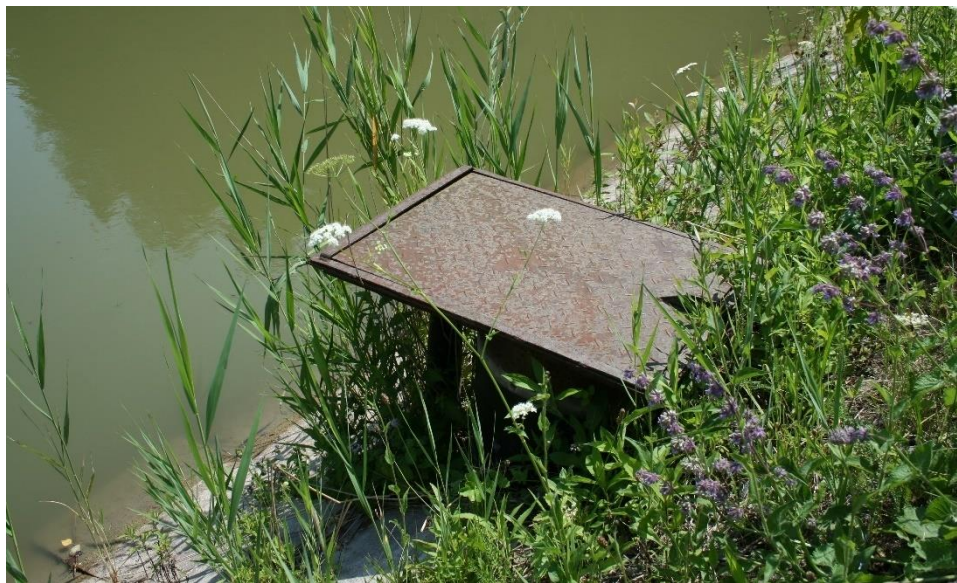
Obr. 5.8 Výpustné zařízení - celokovový požerák, květen 2016 (Koudelková)
