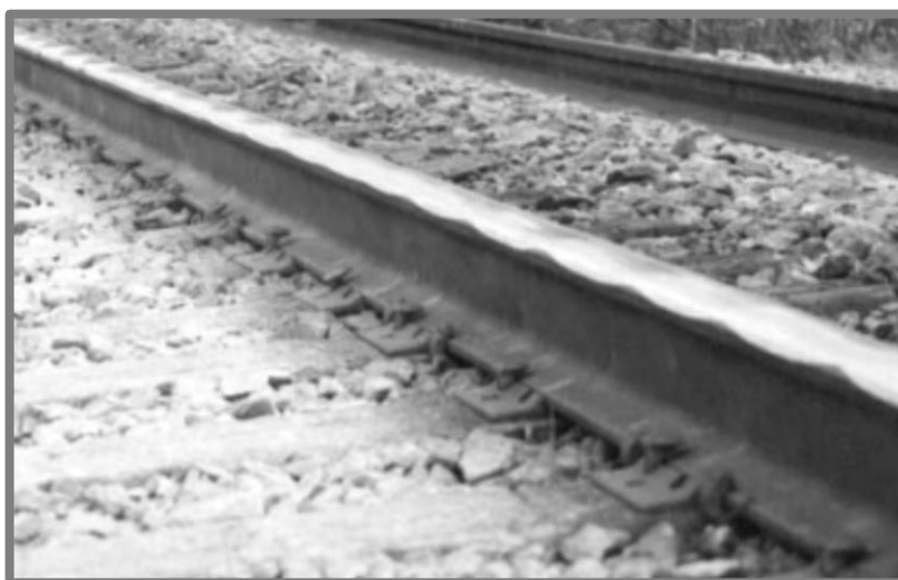
Obr. 3-25 Defekt kolejnic - zvlnění [45]
