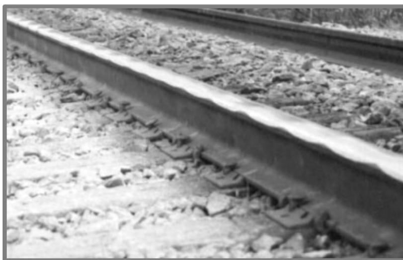
Obr. 3-25 Defekt kolejnic - zvlnění [45]
